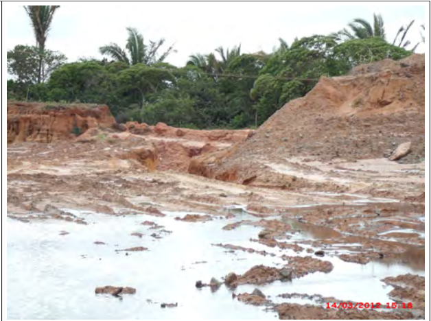
Foto 14 C: Drenagem do Pátio de Carvão causando erosão e carreamento de sólidos para APP.
