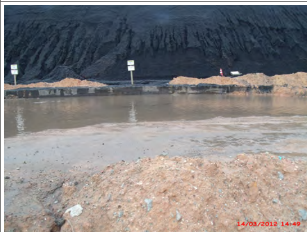
Foto 05 C: Condições estruturais da Pilha de Carvão após chuvas, e transbordo de carvão para área externa ao Pátio.
