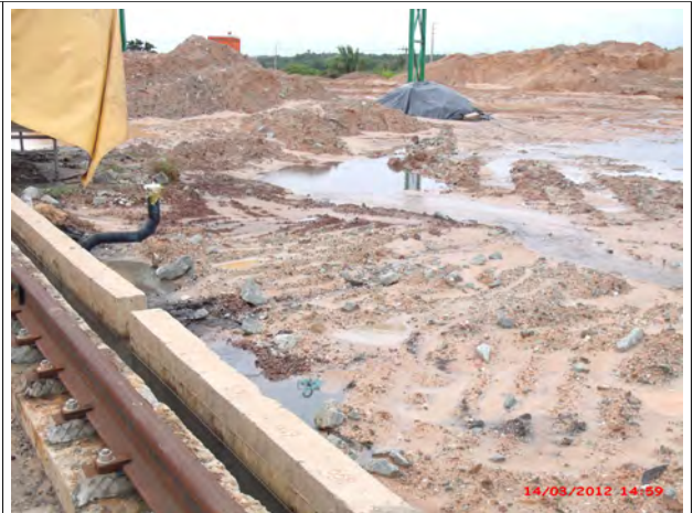
Foto 08 C: Área afetada pelo sistema de drenagem do pátio de Carvão.
