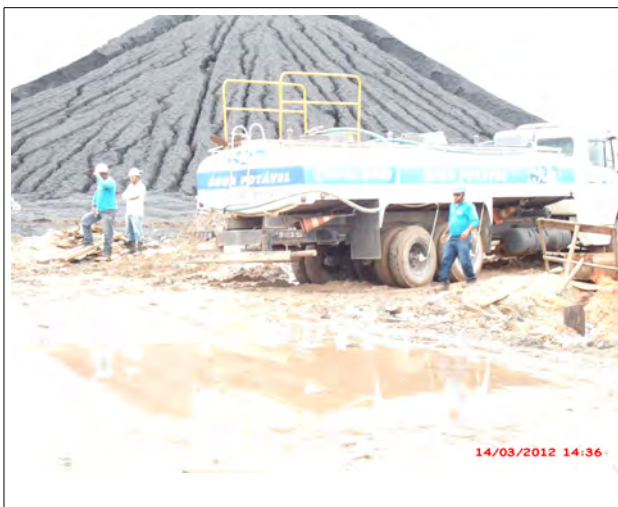
Foto 01 C: Caminhão Pipa recolhendo a água de drenagem do retida no Pátio de Carvão.
