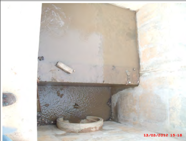
Foto 05 A: Caixa de direcionamento da água de drenagem do Pátio de Carvão.
