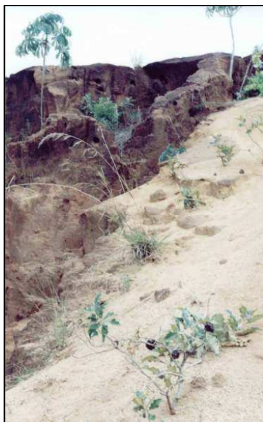
Figura 22: Processo erosivo localizado próximo ao limite do empreendimento.
