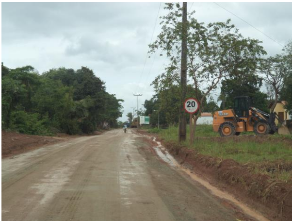
Foto 16-29: Condições de pavimento, circulação de veículos e sinalização do Acesso SR07, Monte Lindo II, Anajatuba/MA. Fonte: Acervo Amplo, 2014.
