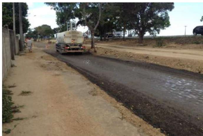
Foto 6.3.2-6 Obras de implantação de vias locais às margens da BR-101 no distrito de Jacupemba em Aracruz (pista sul)
