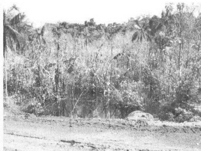
Figura 17: bueiro ármico deteriorado causando alagamento do curso d'água e mortandade da vegetação (Coordenadas UTM 19N 751687 / 25609)
