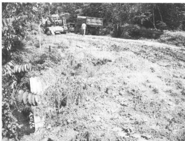
Figura 16: substituição de 02 bueiros ármicos por dois bueiros simples de concreto – diâmetro de 01 metro (Coordenadas UTM 19N 745225 / 19449)
