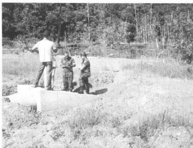
Figura 14: bueiro simples de concreto, já implantado, com área de alagamento e assoreamento lateral à rodovia (Coordenadas UTM 19N 738468 / 5132)
