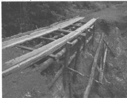
Ponte condenada e bueiro destruído
