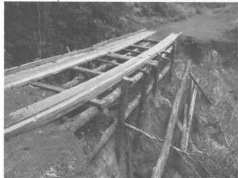
Ponte condenada e bueiro destruído
