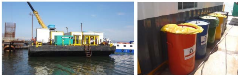
Imagem 7 – Coletores instalados sobre as balsas
