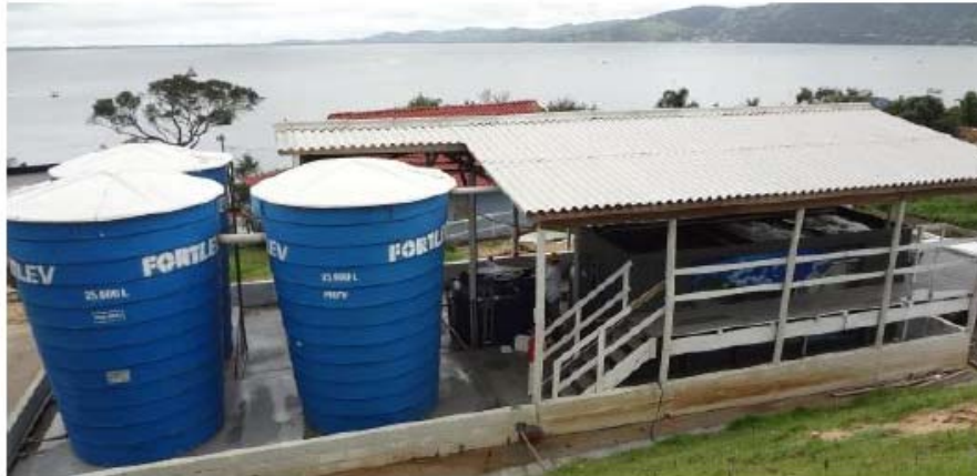
Imagem 02: Estação de Tratamento de Efluentes
