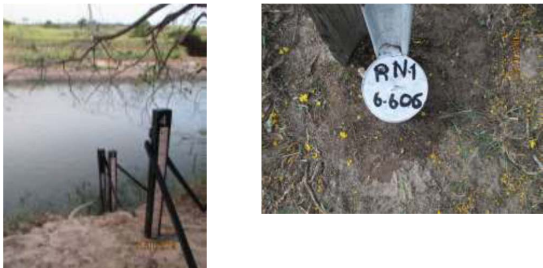
Figura 7 – Seção de Réguas e Referência de Nível da estação fluviométrica UHE Santa Clara CGH Pampã
