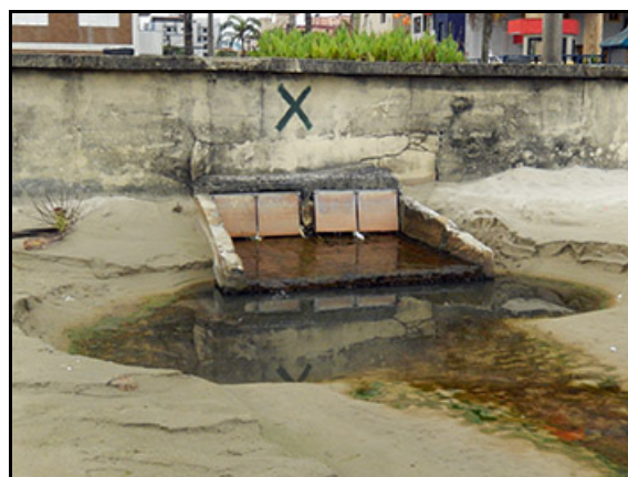
Figura V.3-9 - Vista de comporta para drenagem de águas pluviais, localizada na Praia Vila Caiçara, em Praia Grande, próximo à área prevista para a instalação do cabo.
