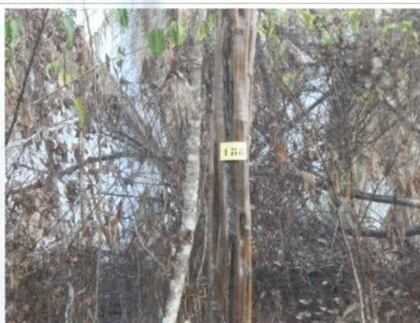
Foto 14 – Poste de madeira da rede atual, vendo-se ao seu redor a vegetação atingida por incêndio florestal.
