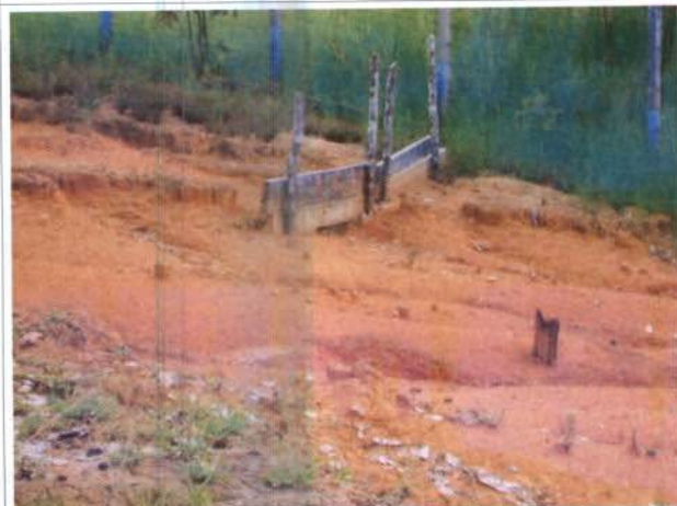
Foto 11 - Tentativa de conter erosão na área da Estação Aristóteles.
