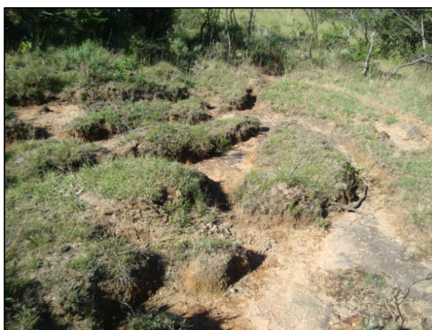
Figura 10. Processos erosivos existentes na área.
