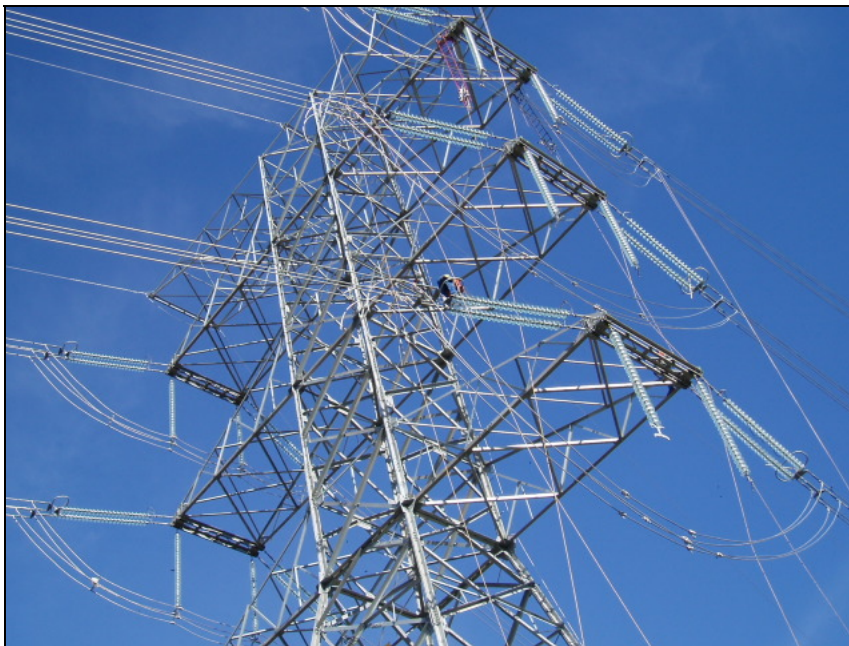
Figura 3.4.7.3.o Detalhe de “Jumper”
