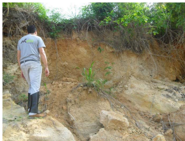
Figura 22: Detalhe da encosta do Rio Campo Grande onde verificou-se vestígios de solapamento no relevo originados pelo aumento da quantidade e velocidade das águas deste rio, a cerca de 3,0m de altitude da cota verificada em campo.
