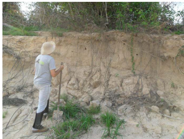
Figura 76: Detalhe do solapamento do solo a margem esquerda do Rio Araguaia instalado em solo arenoso (coordenadas UTM 612644 E/ 8982054 N).
