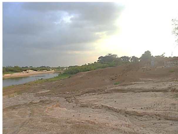
Figura 26: Detalhe da encosta do Rio Araguaia onde verificou-se vestígios de erosão de margem no relevo originados pelo aumento da quantidade e velocidade das águas deste rio, a cerca de 5,0 m de altitude da cota verificada em campo (141 m - coordenadas UTM 609864 E/ 8979559 N)
