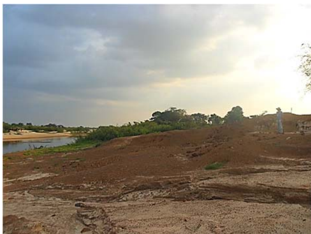
Figura 71: Aspecto geral de sulcos erosivos oriundos de escoamentos de água direcionados ao Rio Araguaia (coordenadas UTM 609864 E/ 8979559 N).
