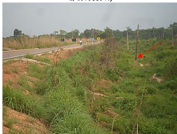
Figura 28: Detalhe da marca em poste paralelo na rodovia PA-411 a cerca de 2,0 m da superfície (coordenadas UTM 612657 E/ 8982059 N)
