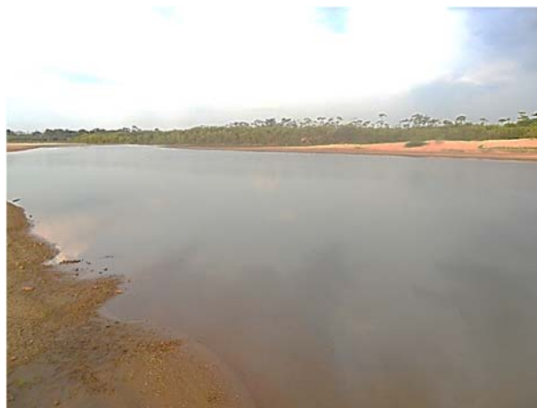
Figura 72: Detalhe do ponto que recebe o escoamento direcionado dos sulcos erosivos as margens do Rio Araguaia (coordenadas UTM 609864 E/ 8979559 N).
