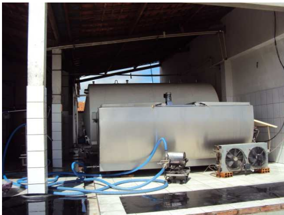
Equipamento de Resfriamento
