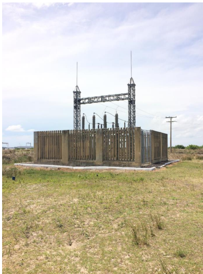
Figura A.7 - Estrutura de Transição existente (Subterrânea-Aérea) da Linha de Distribuição CEEE em São José do Norte – Margem direita
