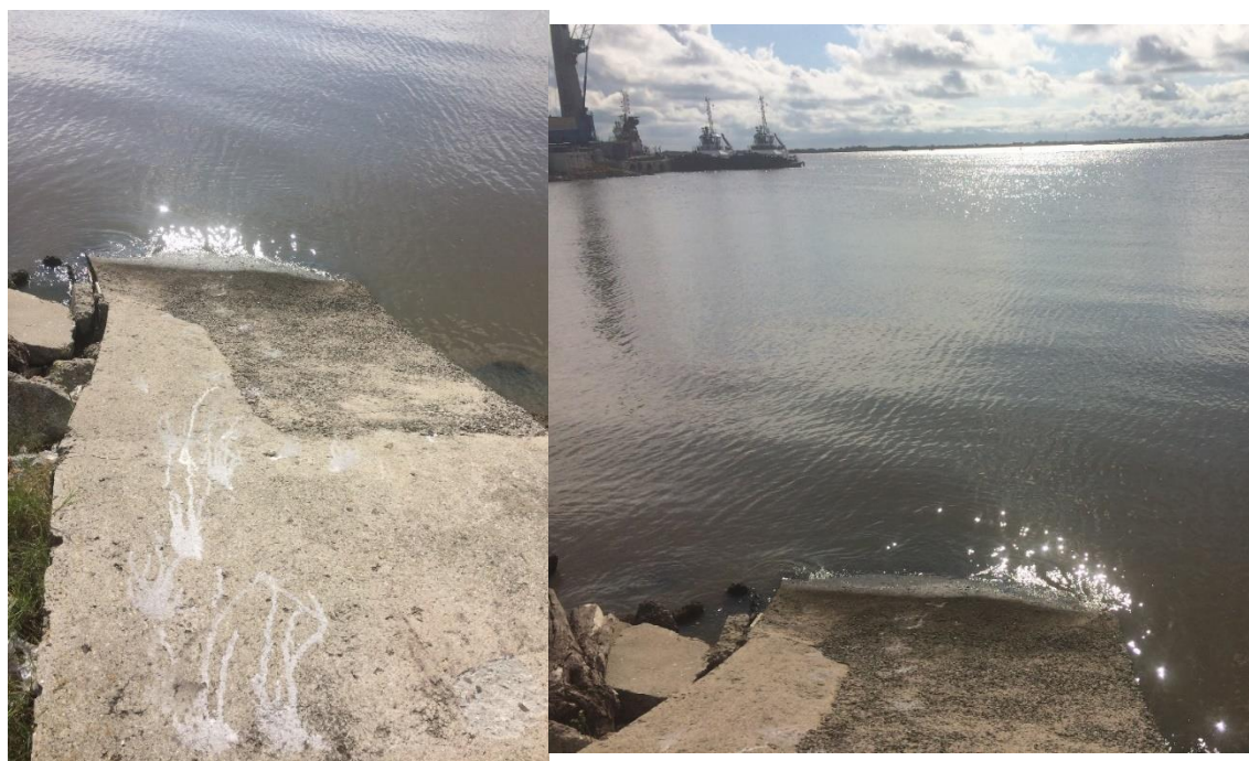
Figura A.6 - Ponto em que os Cabos da Linha da CEEE passam de subterrâneos para subaquáticos, na margem esquerda do canal de Rio Grande
