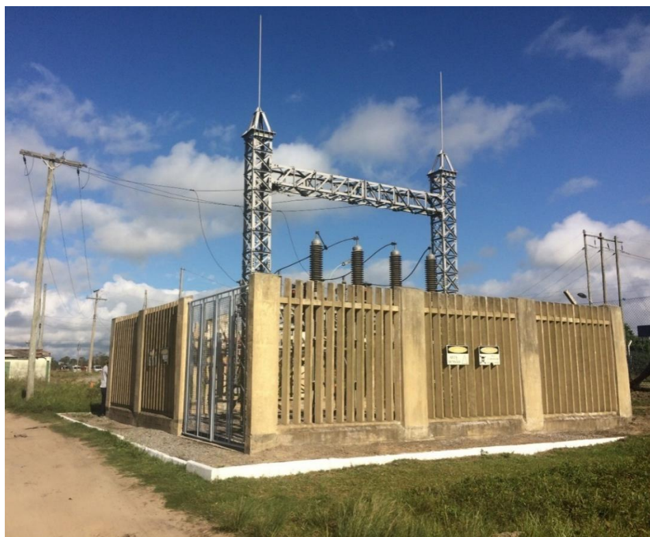
Figura A.5 - Estrutura de Transição existente (Área-Subterrânea) da Linha de Distribuição CEEE em Rio Grande – Margem Esquerda
