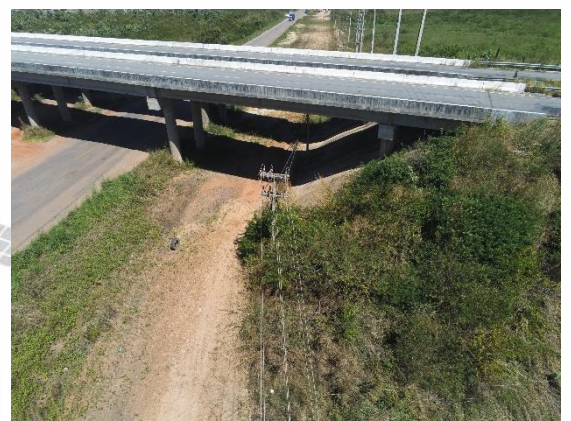
Foto 14 - Rede de Baixa (por baixo do viaduto)
