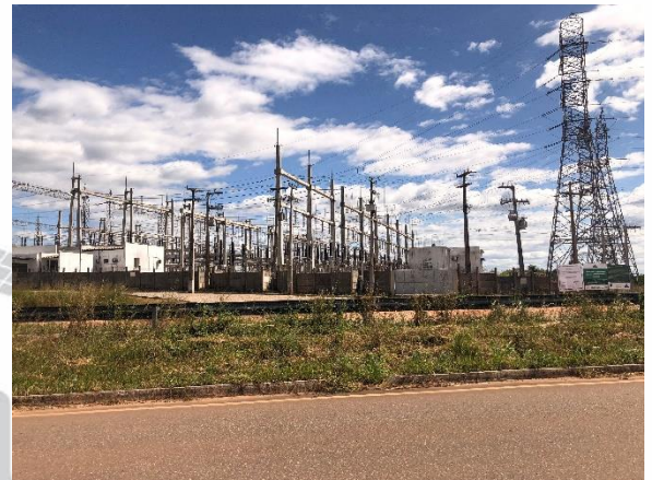
Foto 23 - Subestação Pecém II
