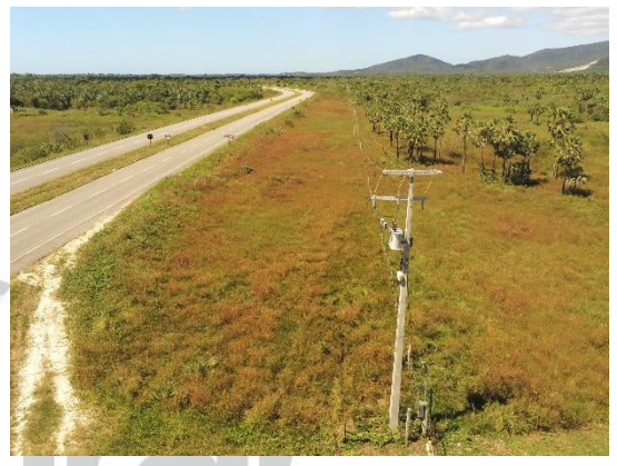
Foto 09A - Rede elétrica vai até rotatória CE085/CE421
