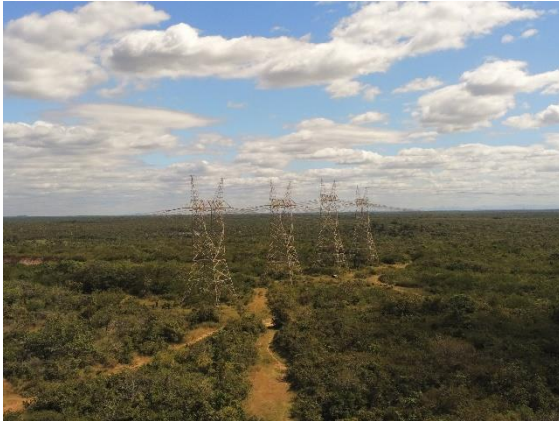
Foto 19 - Torre de Alta Tensão
