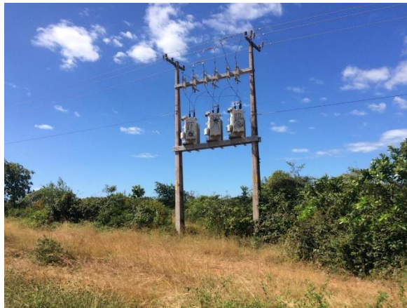
Foto 22 - Transformadores próximo à Subestação Pecém II
