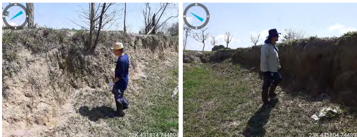
Figuras 4.8 e 4.9: Análise de perfis de barranco na ADA (arredores do PT076).
