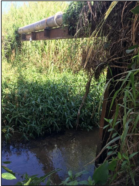
Figura 6.1.125 – Tubulação de gás cruzando o Ribeirão Caçapava Velha no Ponto Amostral 2. Data: 26/05/2022.
