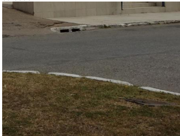
Foto 6.5-12 - Caixa coletora da água da chuva (boca-de-lobo) do sistema de drenagem pluvial da sede.
