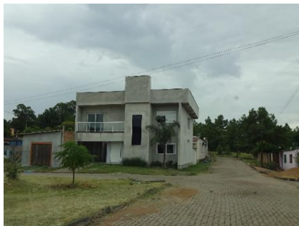
Foto 6.5-95 - Edificação em construção com médio padrão construtivo, com estrutura mista (independente e alvenaria portante).
