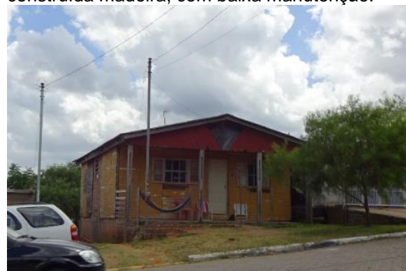
Foto 6.5-29 - Casa de baixo padrão construtivo, construída madeira, com baixa manutenção.
