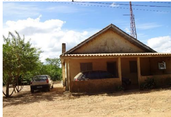
Foto 6.5-189 - Casa de médio padrão construtivo, construída em alvenaria em mal estado de conservação.
