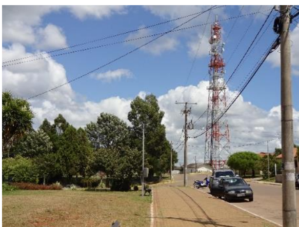
Foto 6.5-15 - Antena de telecomunicação.
