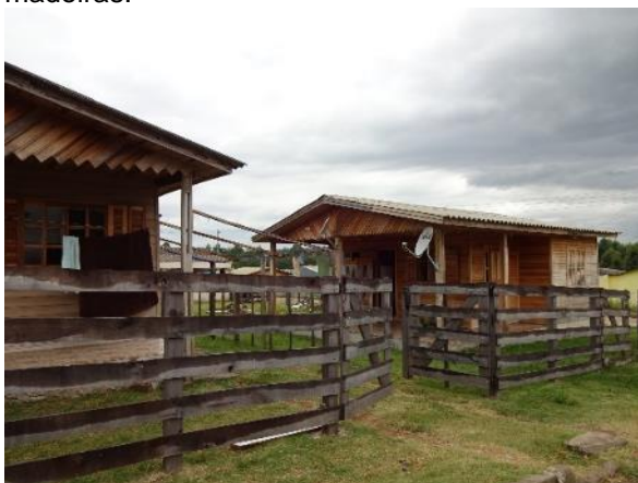
Foto 6.5-94 - Casas pré-fabricadas de madeira, relativamente novas, porém refletem prematuro deterioro por falta de proteção (pintura) das madeiras.
