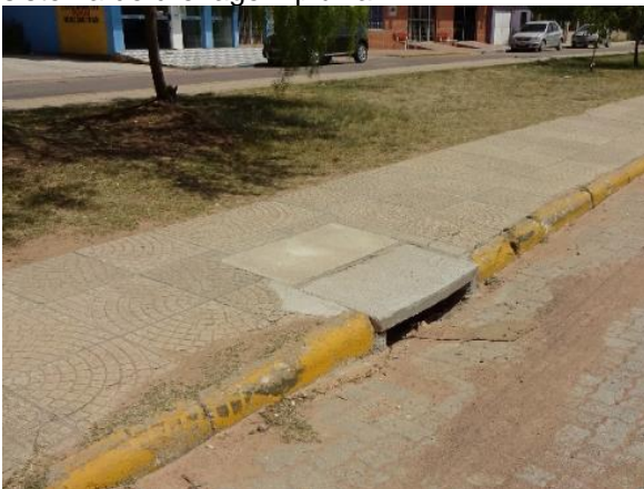
Foto 6.5-147 - Caixa coletora (boca-de-lobo) do sistema de drenagem pluvial.
