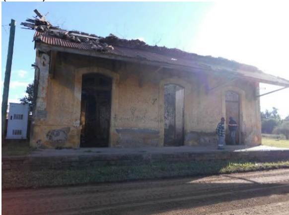
Foto 6.5-231 - Antiga Estação Santa Rosa (Seival) em ruínas.
