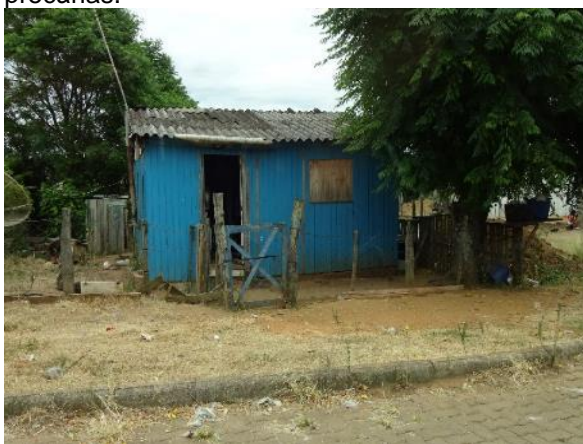
Foto 6.5-109 - Habitação precária, com estrutura e vedação em madeira bruta, e aberturas precárias.
