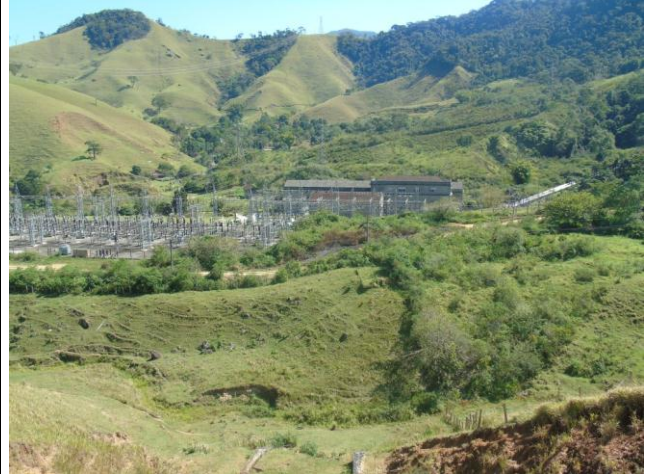
Usina Hidrelétrica e Subestação
