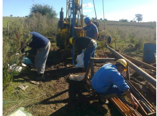
Figura 5.19 - Implantação do pré-filtro no poço de monitoramento PM03B.
