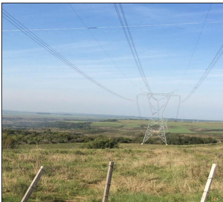
Foto 41: Área da propriedade que já tem linha de transmissão instalada.
