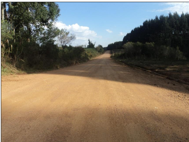
Foto 70: Situação da Rodovia RS-608, em trecho próximo ao cruzamento denominado “Quatro Bocas”, distrito de Arroio Mau, Pedras Altas.
