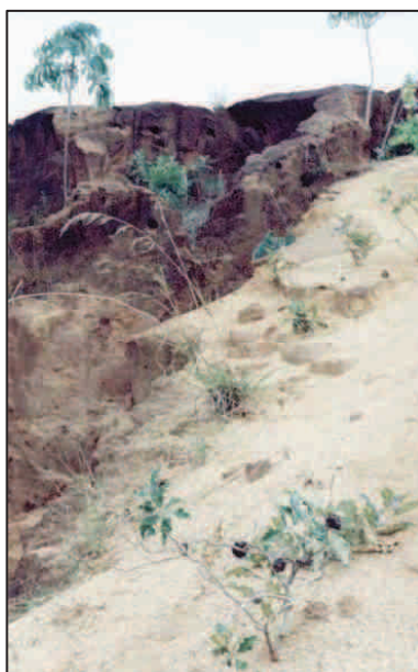
Figura 5.2.3.2-1: Processo erosivo localizado próximo ao limite do empreendimento.
