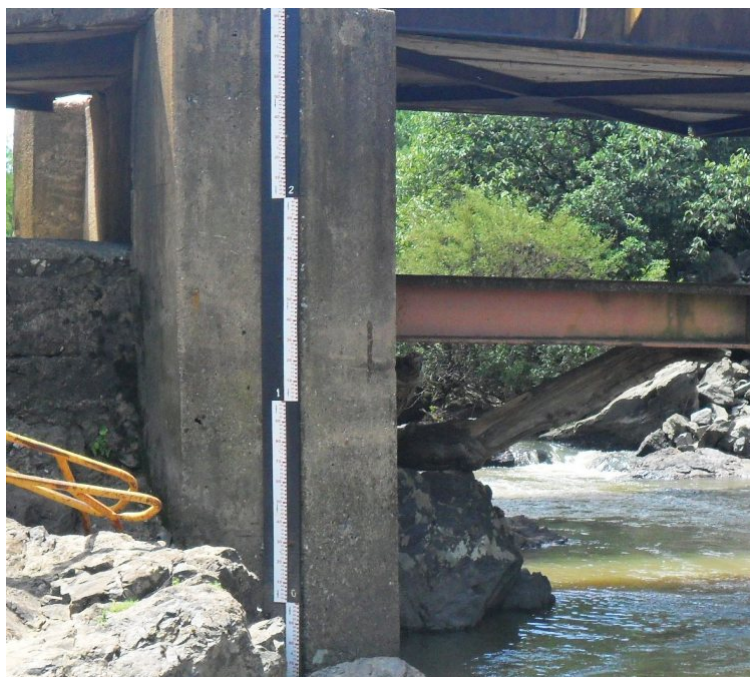
Figura 1: Régua linimétrica instalada no Arroio Candiota Jusante. Fonte: ECOSSIS, 2015.
