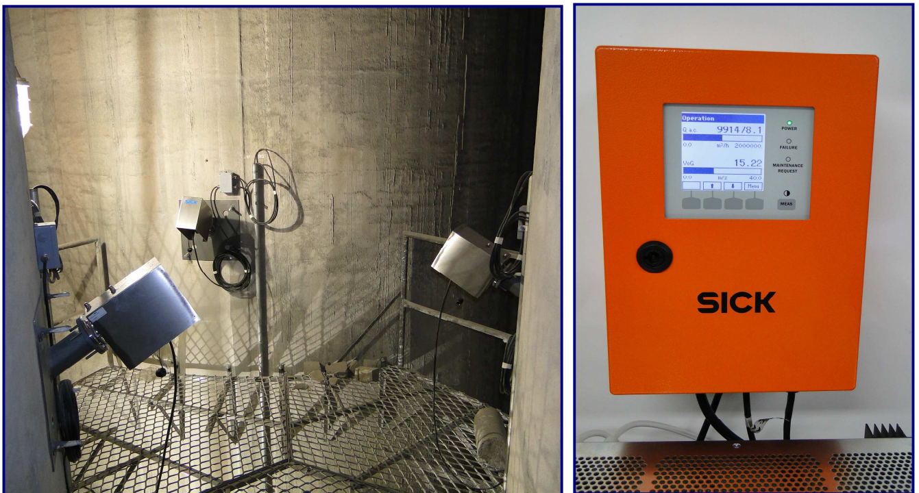
Figura 4 – Sensores e Controlador do Medidor de Vazão.
