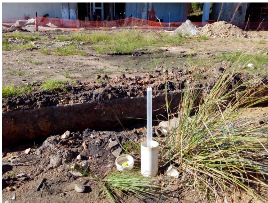
Figura 6. Fotografia mostrando o poço PM-18 e a escavação executada na sua imediação que danificou a estrutura do mesmo. Note que o amostrador pode ser introduzido somente até o ponto onde o tubo apresenta deslocamento lateral, impedindo a coleta de amostras.
