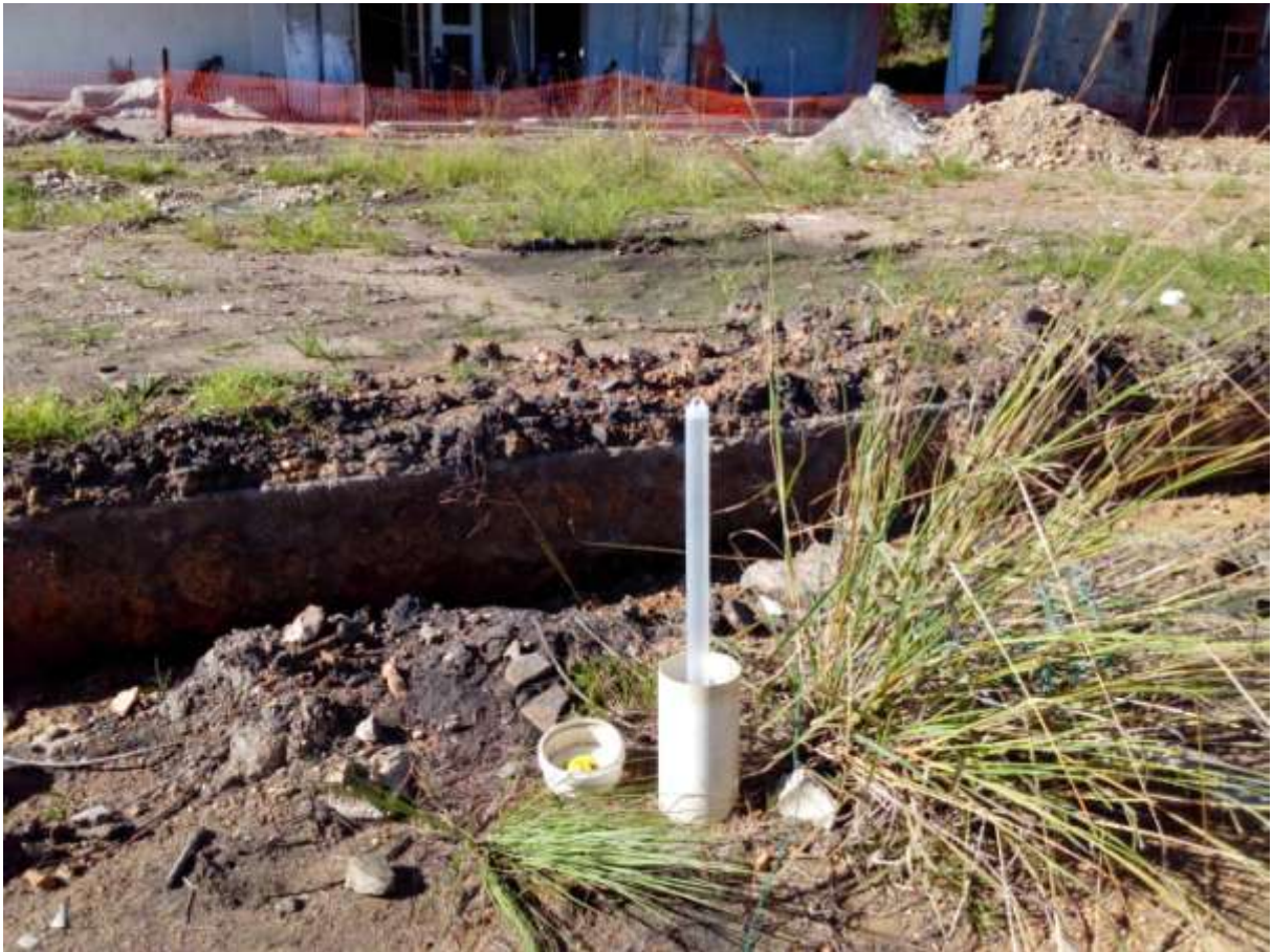
Figura 6. Fotografia mostrando o poço PM-18 e a escavação executada na sua imediação que danificou a estrutura do mesmo. Note que o amostrador pode ser introduzido somente até o ponto onde o tubo apresenta deslocamento lateral, impedindo a coleta de amostras.
