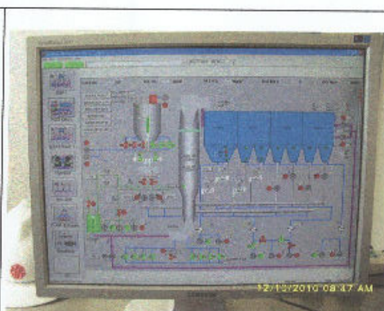
Figura 5 – Tela de Comando Principal do FGD – 350 MW
