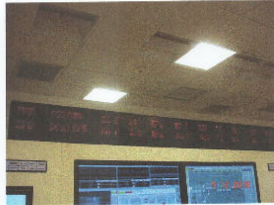
Figura 2 – Painel da sala de controle central
