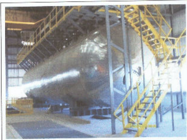
Foto 33 Desaerador montado e em operação
