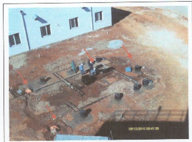
Foto 82 Estação de Tratamento de Efluentes Sanitários (setas indicam os medidores de turbidez e vazão)
