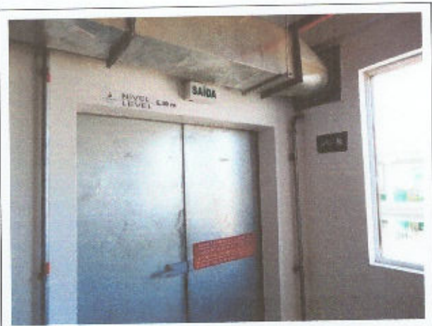
Foto 20 Acesso no Prédio de Controle - porta corta fogo e sinalização
