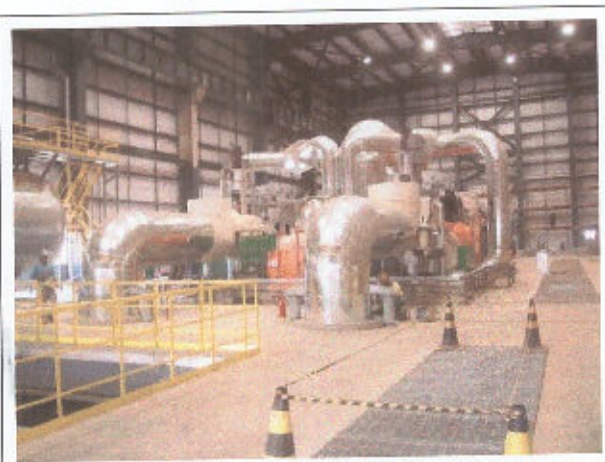
Foto 43 Turbina - foto do lado de admissão de vapor superaquecido e reaquecido
