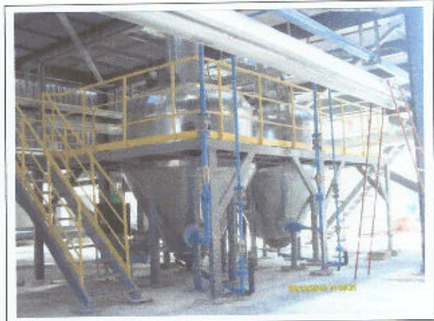
Foto 96 Propulsores para transporte pneumático de cinza ao silo - Precipitador Eletrostático 1
