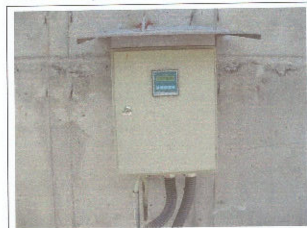
Foto 72 Medidor de Cloro no Clarificador do sistema de tratamento de água
