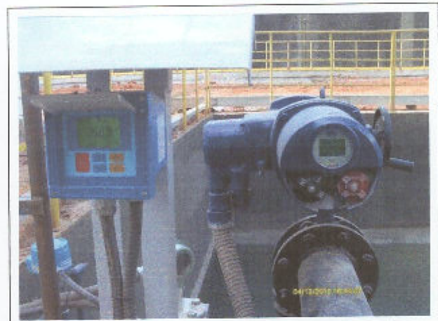
Foto 77 Medidores de pH e Vazão na bacia da estação de tratamento de efluente industriais
