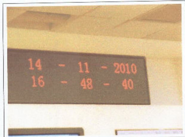
Foto 30 Painel da sala de comando principal
