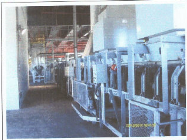
Foto 85 Corriente do carvão, com filtro de mangas para despoiramento (fundo à esq.)
