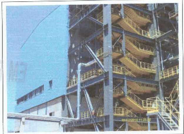
Foto 32 Caldeira (dir.) - montagem concluída e em operação
