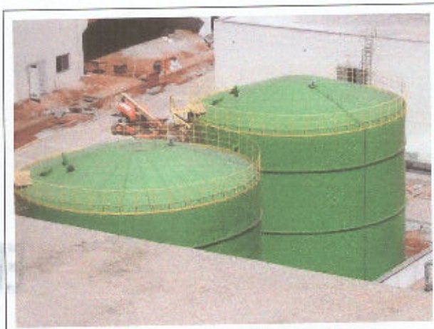
Foto 69 Tanques de água desmineralizada (tanques verdes)
