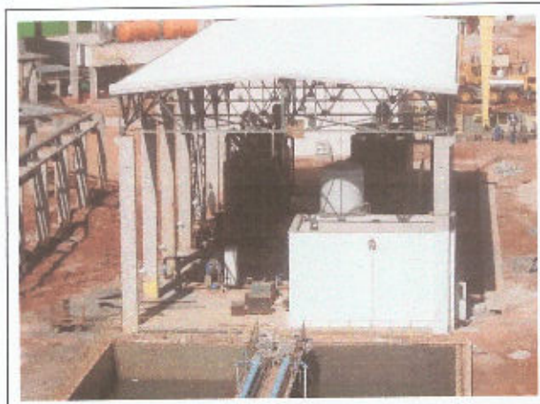
Foto 76 Estação de tratamento de efluentes industriais (bacias em 1º plano), sala de comando (dir.)
