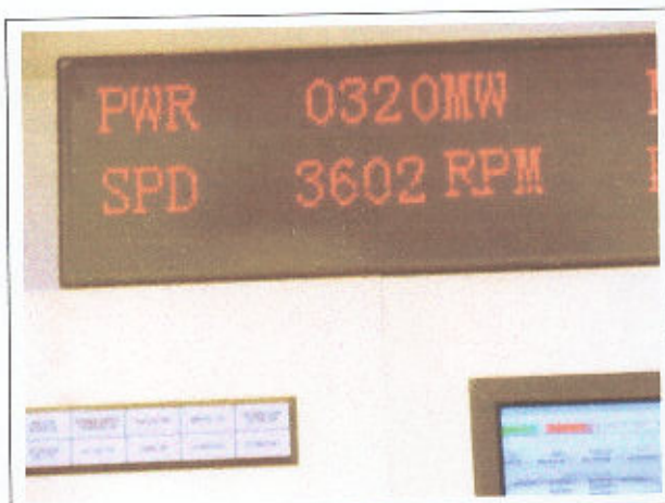
Foto 29 Painel da sala de comando principal
