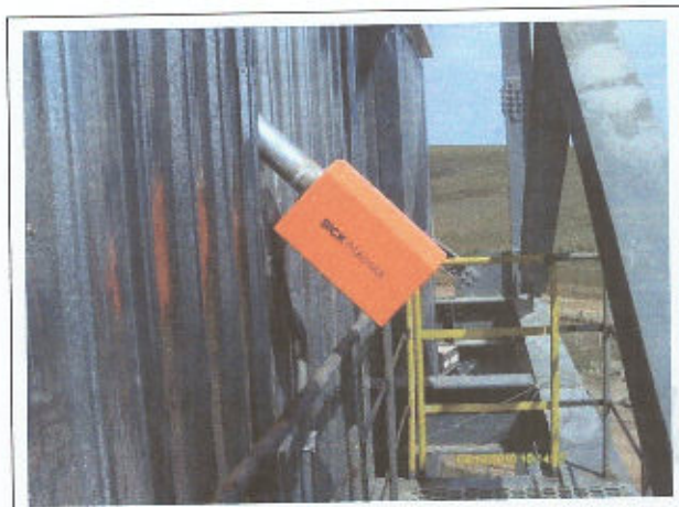
Foto 59 Medidor de vazão dos gases do sistema de monitoramento contínuo dos gases de combustão no duto de saída do Precipitador Eletrostático 2 – monitoramento das emissões atmosféricas
