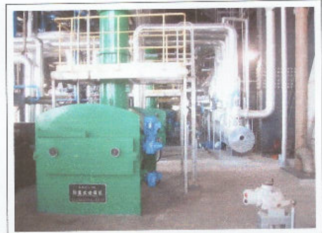
Foto 34 Mesa Dosadora do Carvão montado e em operação
