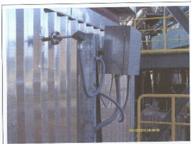
Foto 56 Sonda do analisador de gases do sistema de monitoramento contínuo dos gases de combustão no duto de saída do Precipitador Eletrostático 1
