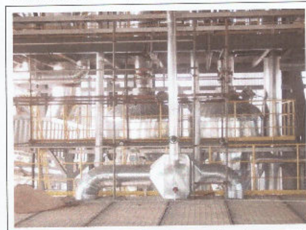
Foto 92 Propulsores para transporte pneumático de subproduto do FGD ao silo de subproduto
