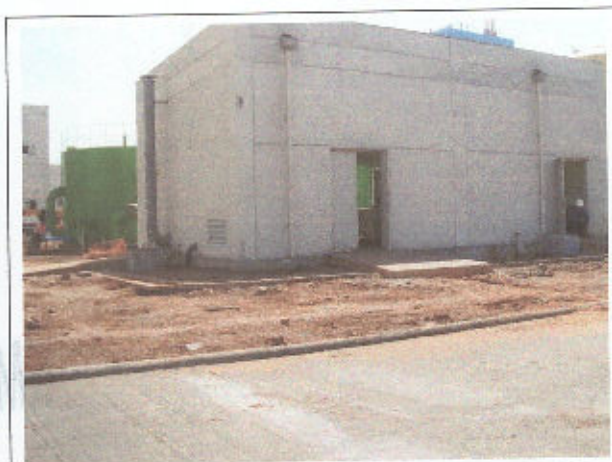
Foto 10 Acesso a sala de localização da centrífuga de retirada da lama do Sistema de Tratamento de Água - concluído
