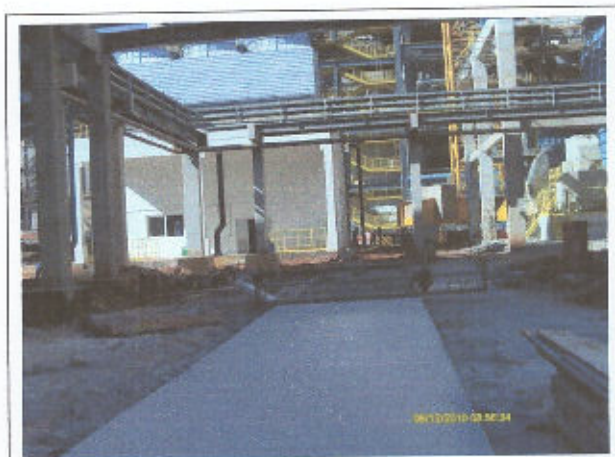
Foto 11 Via de acesso a Área de Abastecimento de Cal em fase de conclusão
