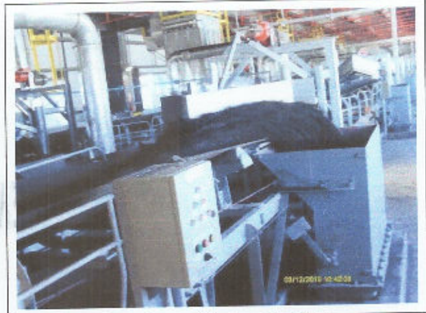
Foto 86 Corriente carvão, com filtro de mangas para despoiramento (fundo ao centro)
