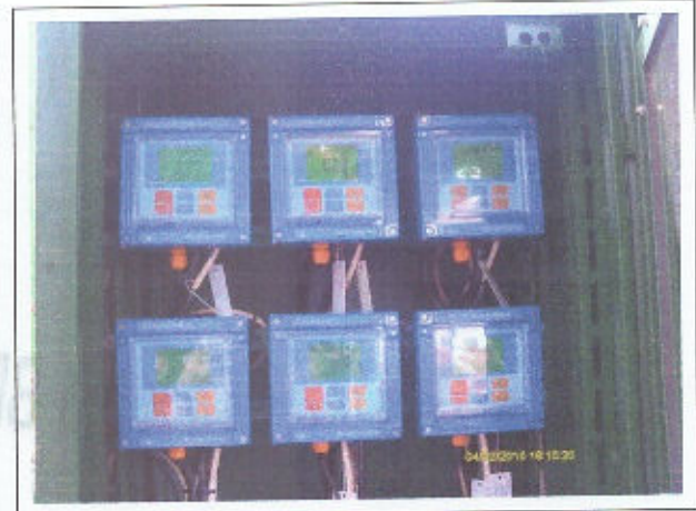
Foto 75 Medidores da qualidade da água do Sistema de desmineralização
