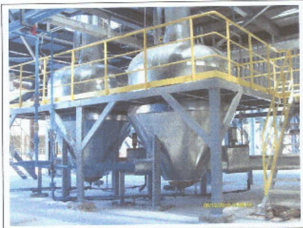
Foto 95 Propulsores para transporte pneumático de cinza ao silo - Precipitador Eletrostático 1
