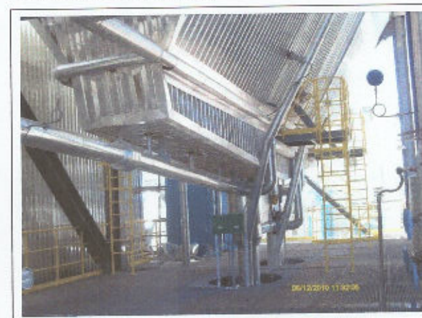
Foto 94 Tremonhas e tubulações iniciais do sistema de transporte de cinza - Precipitador Eletrostático 1
