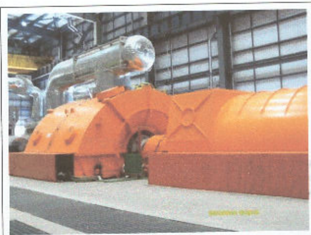
Foto 42 Gerador, no primeiro plano (lado direito) e, turbina a esquerda
