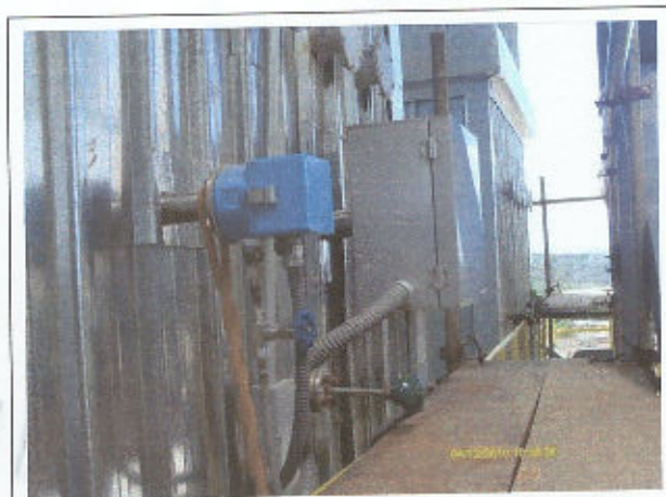
Foto 60 Sonda do analisador de gases e medidor de opacidade do sistema de monitoramento contínuo dos gases de combustão no duto de saída do Precipitador Eletrostático 2 – monitoramento das emissões atmosféricas
