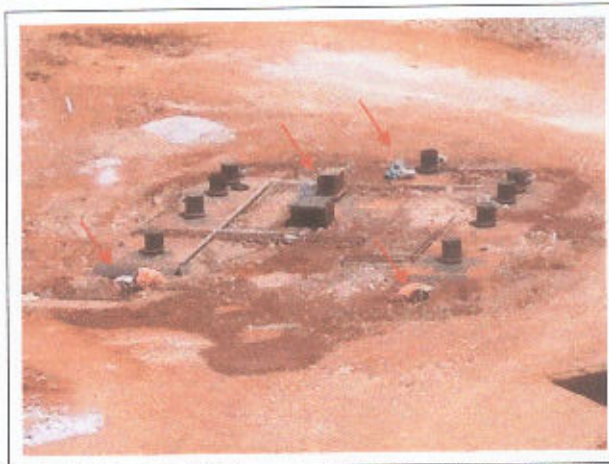
Foto 81 Estação de Tratamento de Efluentes Sanitários (setas indicam os medidores de turbidez e vazão)
