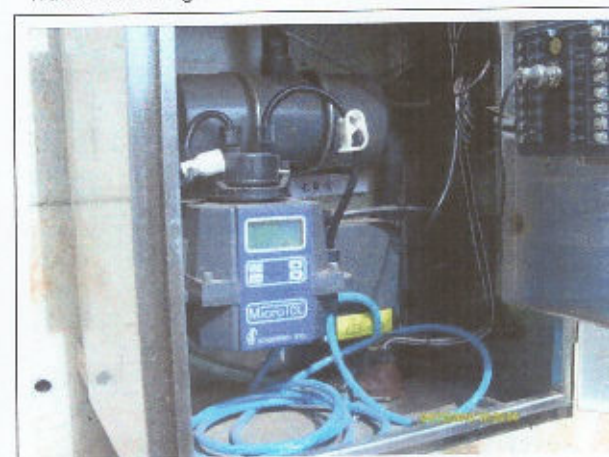
Foto 73 Medidor de turbidez no Clarificador do sistema de tratamento de água
