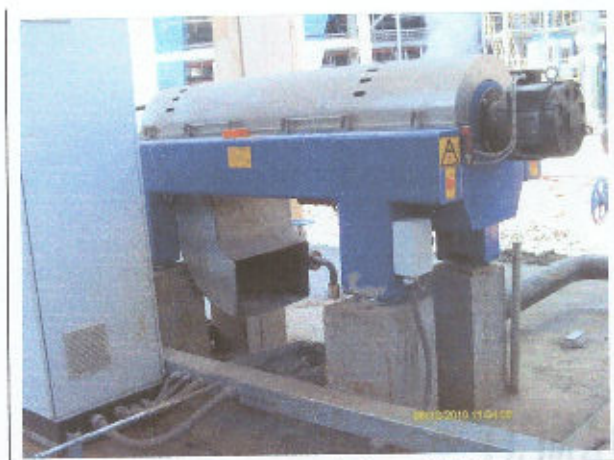
Foto 80 Centrífuga de separação da lama da Estação de tratamento de efluentes industriais
