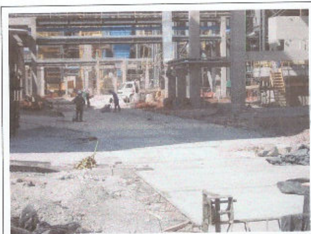
Foto 13 Via de acesso a Área de Remoção da Cinza Leve - em fase de conclusão
