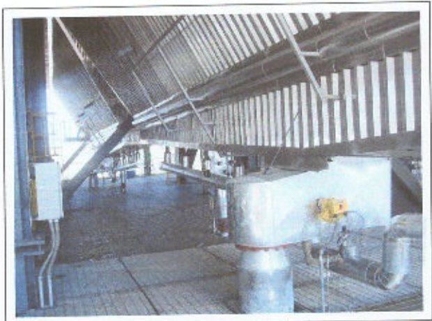
Foto 89 Tremonhas e tubulações iniciais do sistema de transporte de cinza – Precipitador Eletrostático 2
