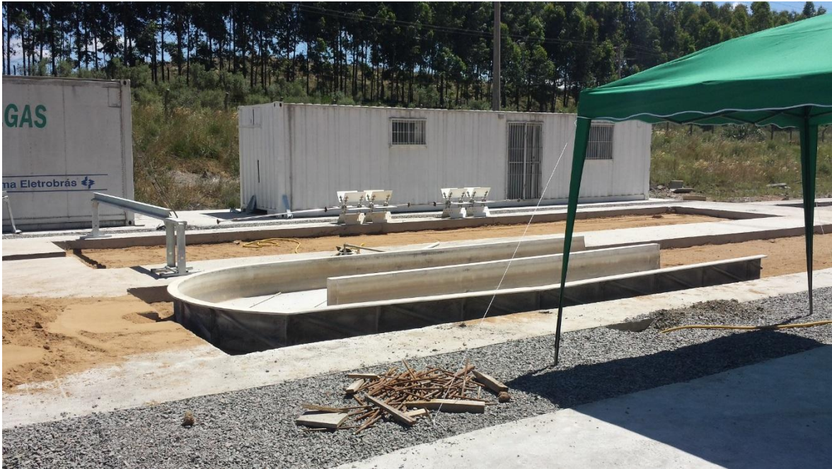
Figura 49: Instalação dos fotobiorreatores e sistema de agitação
