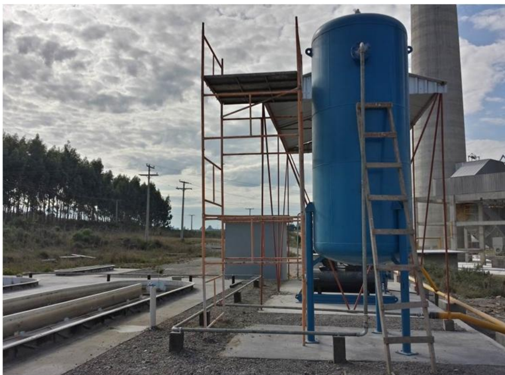
Figura 58: Tubulação de gás do Skid até fotobiorreatores
