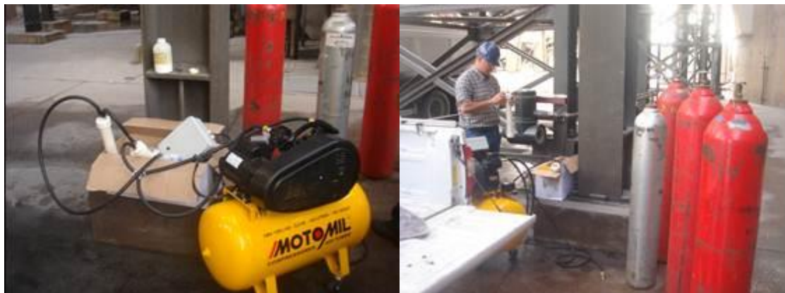
Figura 17: Sistema de captação do gás de combustão – Técnicos do Laboratório Roque L. Zilio e Adriano Arruda Henrard
