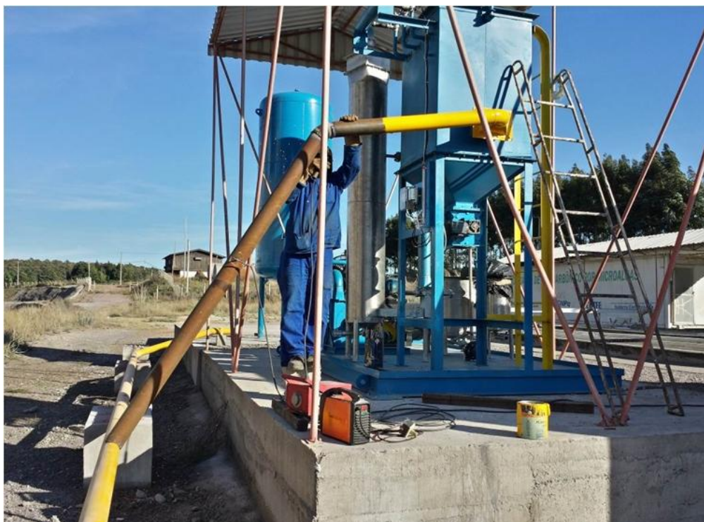
Figura 57: Linha de gás de combustão instalada no Skid
