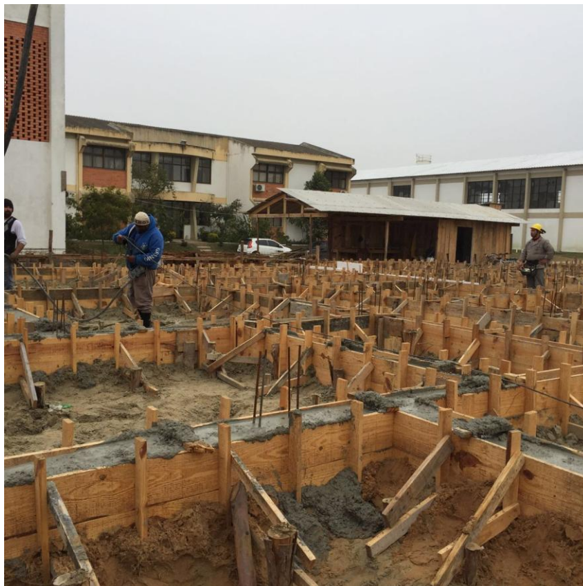
Figura 6: Construção do Centro de Estudos Avançados em Biofixação de CO 2 por Microalgas
