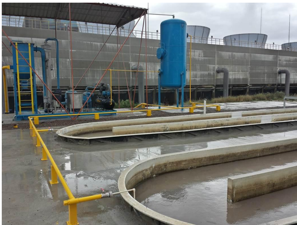
Figura 59: Tubulação de gás do Skid até fotobiorreatores (continuação)
