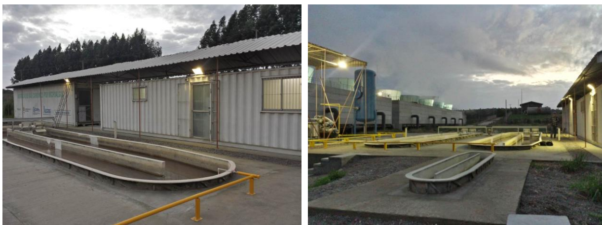
Figura 63: Iluminação externa instalada na Planta Piloto
