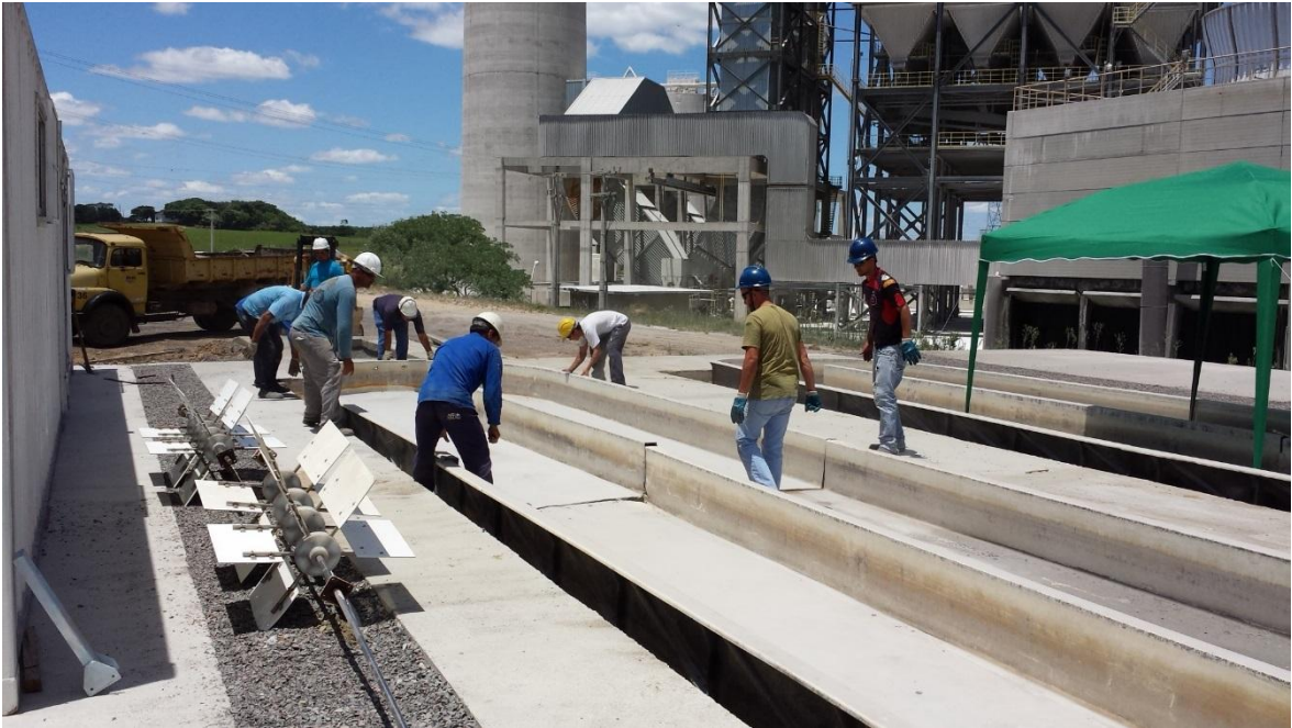
Figura 50: Instalação dos fotobiorreatores e sistema de agitação
