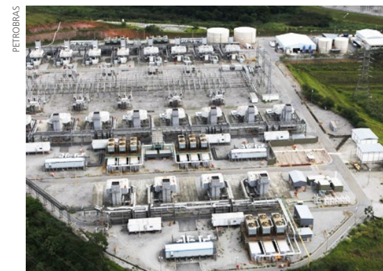
| Usina Termelétrica Termomacaé (Mário Lago)
