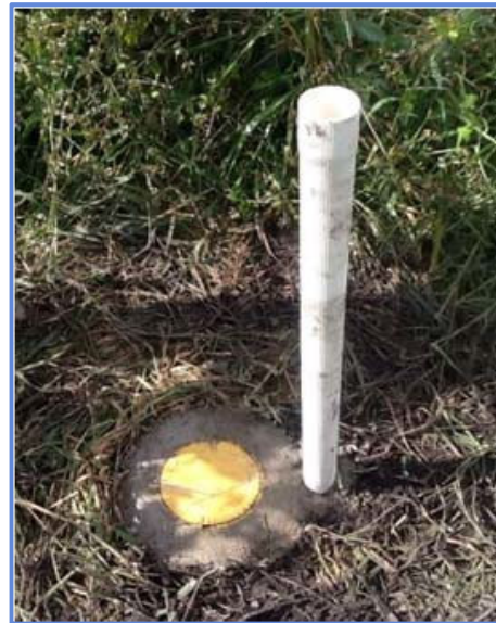
Poço de monitoramento instalado na UTE
