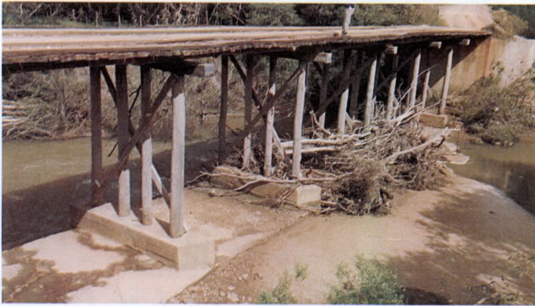
Figura 80. Ponto de Monitoramento 6 (PM6); Destaque para o acúmulo de galhos e espuma marrom.
