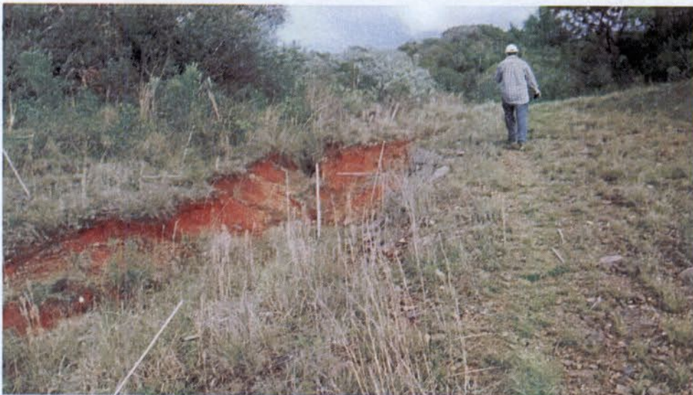
Figura 28. Área 11- Erosão do talude
