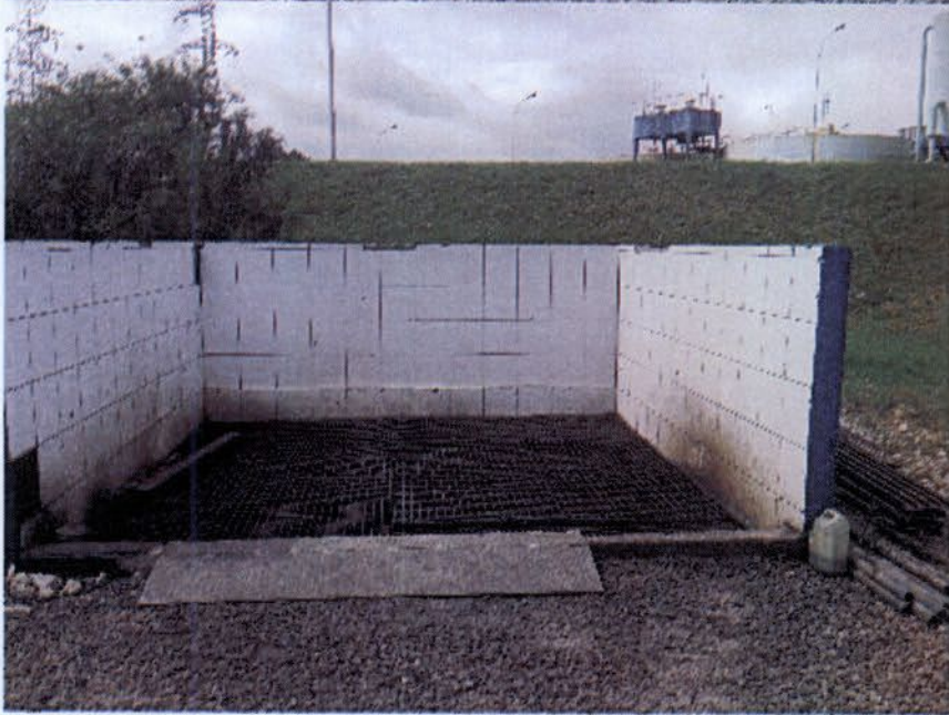
Figura 57: Ponto 1 da figura 56 – Bacia de lavagem de equipamentos
