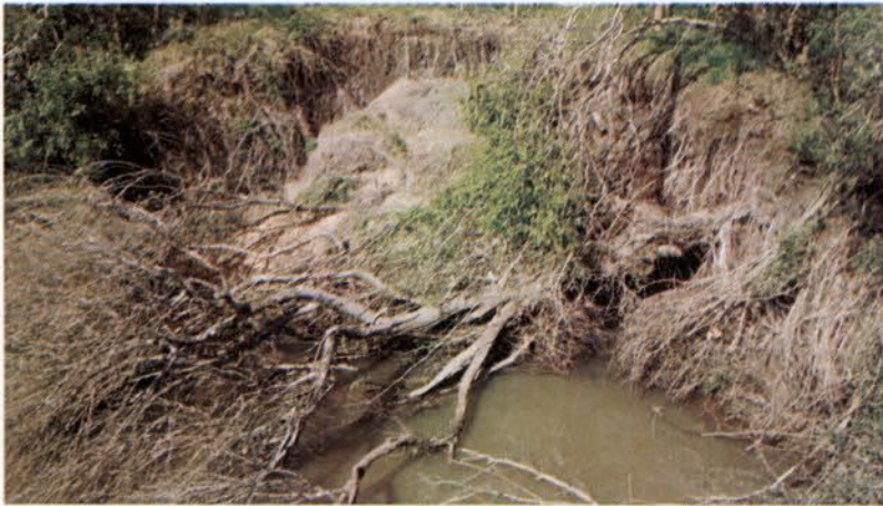
Figura 83. Erosão na margem do rio no PM6
