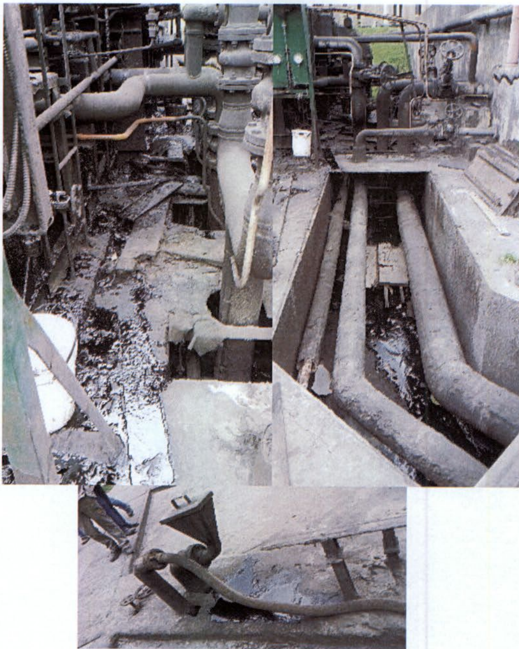
Figura 68: Ponto 4 da figura 56 – Registro de vazamentos de óleo e presença de óleo na drenagem da área de recebimento e transferência de óleo
