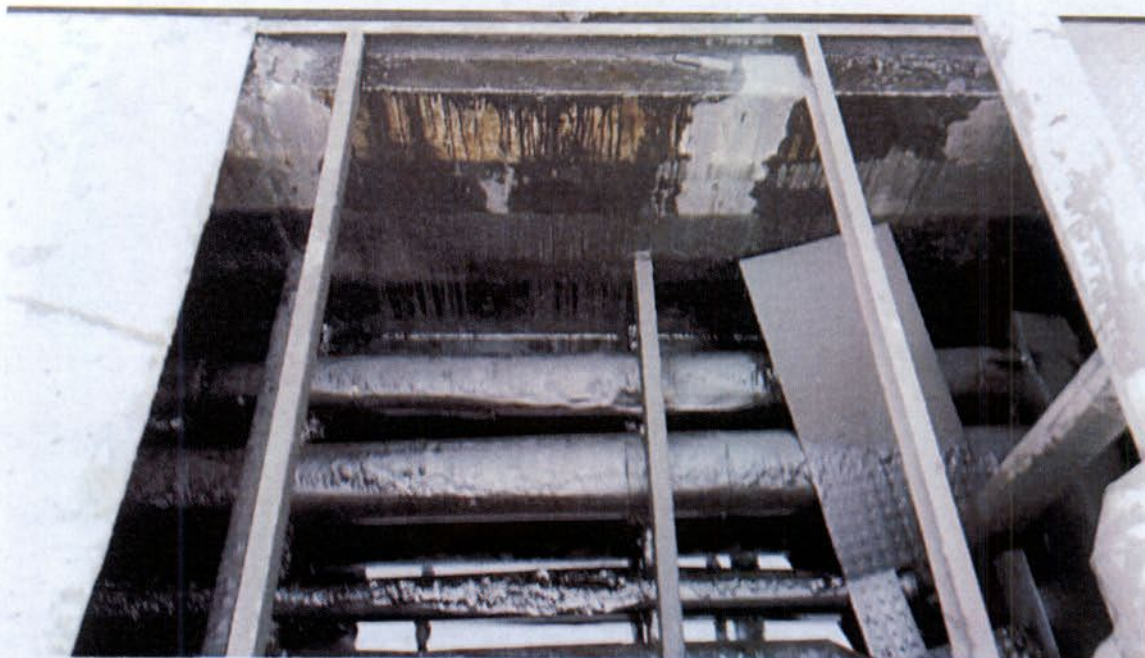
Figura 73: Ponto 4 da figura 56 – Registro óleo na drenagem localizada no sistema de armazenamento e bombeamento de óleo da fase C
