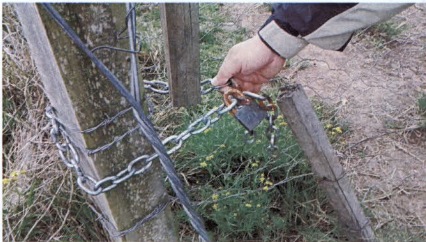
Figura 42. Cerca de divisão das propriedades danificada.
