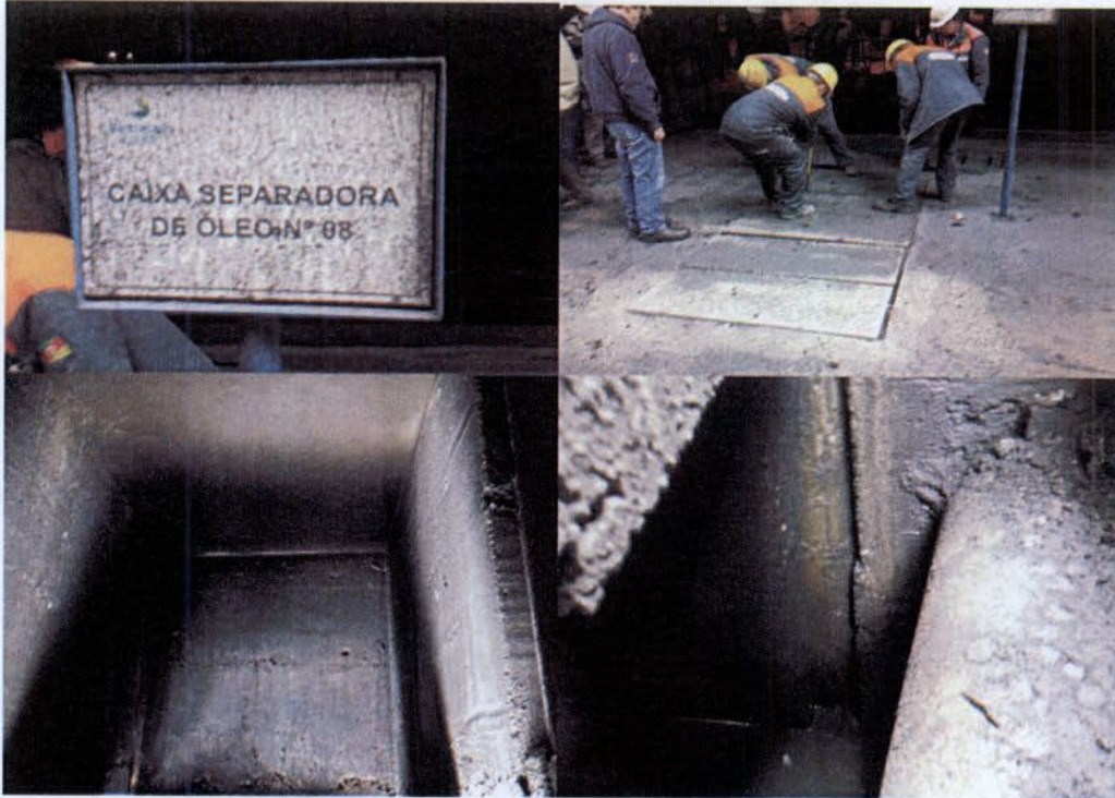
Figura 60: Ponto 2 da figura 56 – Caixa SAO nº 08 sem os compartimentos divisórios que promovem a separação água e óleo
