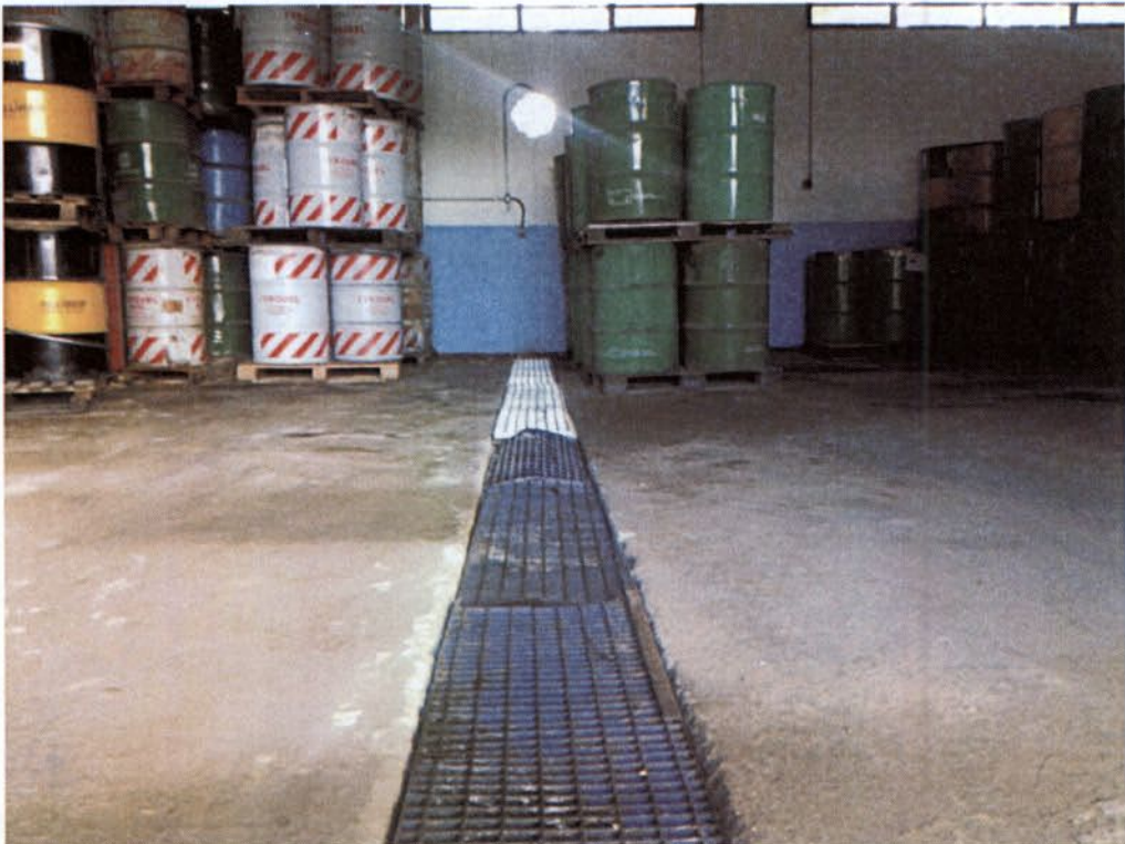
Figura 52: Tambores com resíduos classe I adequadamente acondicionados na área da central destinada para resíduos perigosos
