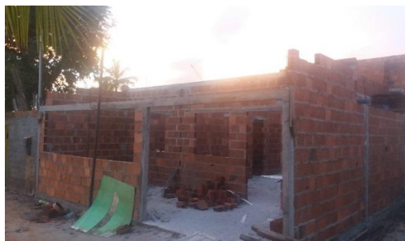
Foto 7.3-34: Visita de acompanhamento social na casa nova do Zé Ivo que está sendo construída no povoado de jatobá
