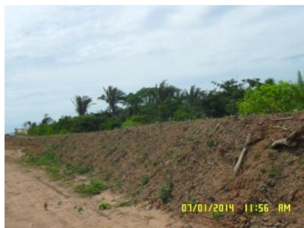
Foto 2-2: Armazenamento temporário de topsoil em leiras dentro da faixa de domínio para posterior reutilização em recuperação de áreas.
