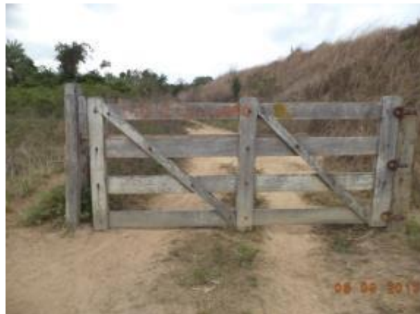
Foto 53: Final do acesso SP08. Encontro com a faixa de domínio da EFC. À direita, talude da EFC. Fonte: Amplo, 2013.
