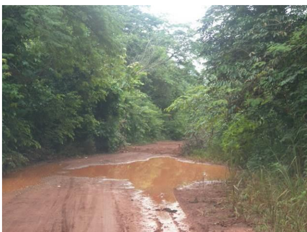
Foto 83: Condições da pavimentação da via de Acesso AC07, em Açailândia/MA. Fonte: Ampla, 2014.
