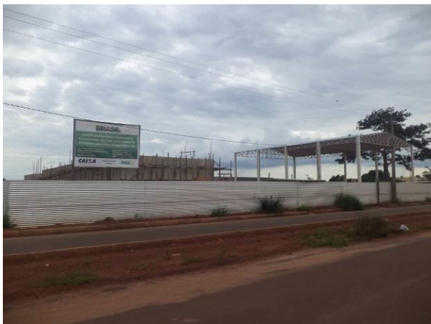
Foto 17: Construção da Praça dos Esportes e da Cultura na localidade Residencial Tropical, em Açailândia/MA. Fonte: Amplo, 2014.
