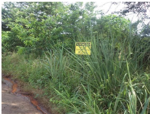
Foto 64: Sinalização coberta pela vegetação no Acesso Viário AC03, em Açailândia/MA. Fonte: Amplo, 2014.
