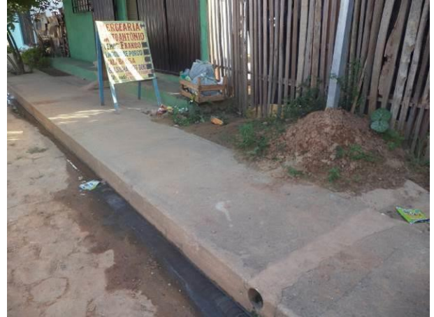
Foto 30: Esgotamento sanitário lançado a céu aberto na Vila Juscelino, em Açailândia/MA. Fonte: Ampla, 2014.
