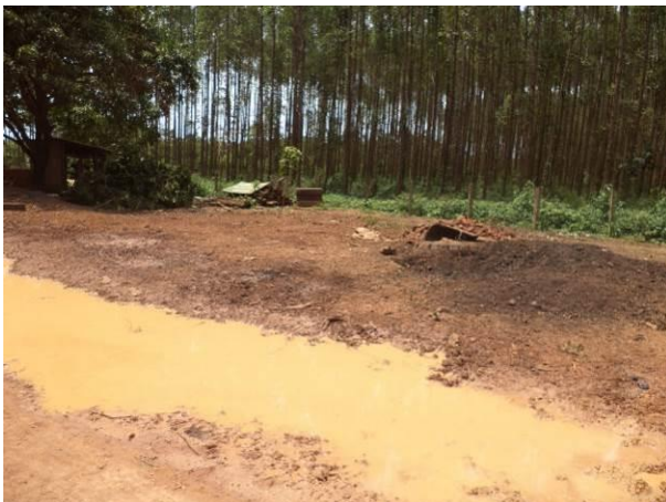
Foto 39: Condições da pavimentação da via de Acesso AC01A, em Açailândia/MA. Fonte: Ampla, 2014.
