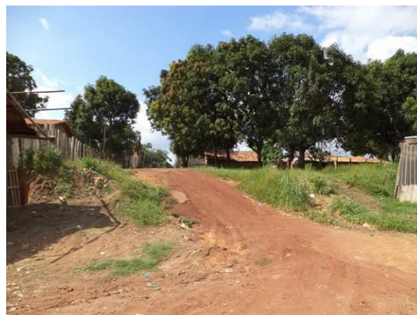
Foto 72: Condições da pavimentação da via de acesso AC04A, em Açailândia/MA. Fonte: Ampla, 2014.
