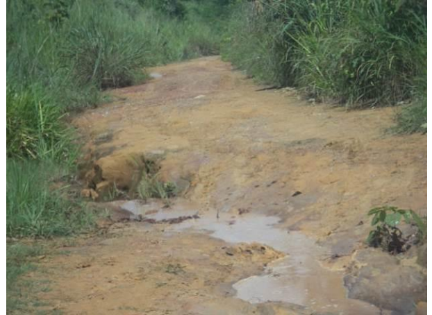
Foto 66: Condições da pavimentação da via de acesso AC02, em Açailândia/MA. Fonte: Ampla, 2014.
