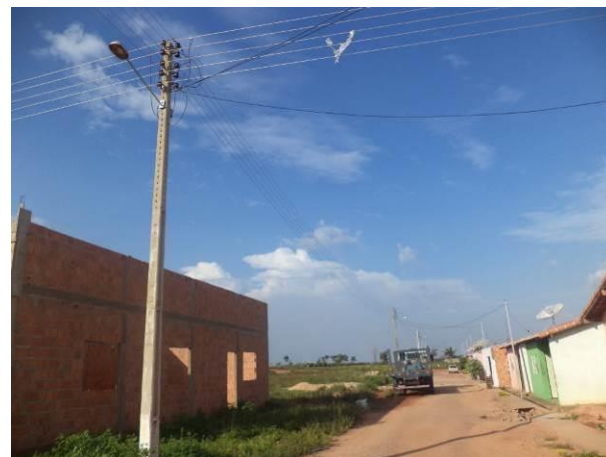
Foto 26: Iluminação Pública da Vila Juscelino, em Açailândia/MA. Fonte: Amplo, 2014.
