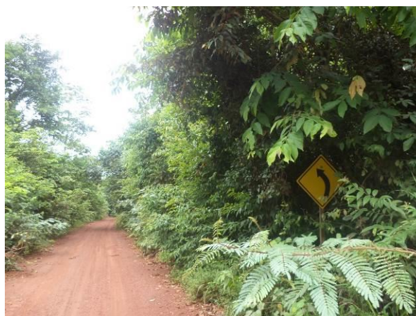
Foto 82: Condições da pavimentação e sinalização coberta pela vegetação no Acesso AC07, em Açailândia/MA. Fonte: Ampla, 2014.
