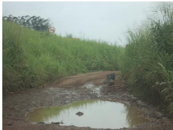
Foto 60: Resíduos sólidos espalhados a céu aberto e condições da pavimentação da via de acesso AC02, em Açailândia/MA. Fonte: Amplo, 2014.
