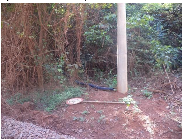
Foto 51: Condições da sinalização no Acesso AC01C, em Açailândia/MA. Fonte: Amplo, 2014.
