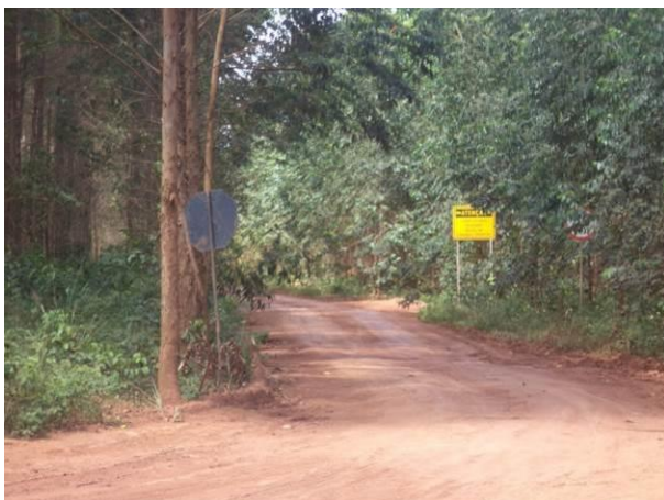
Foto 47: Condições da pavimentação e sinalização do Acesso Viário AC01B, em Açailândia/MA. Fonte: Amplo, 2014.
