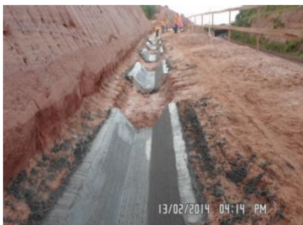
Foto 2-49: Construção ainda parcial da sarjeta; construção das placas de concreto a compor a futura sarjeta (Locação 36).
