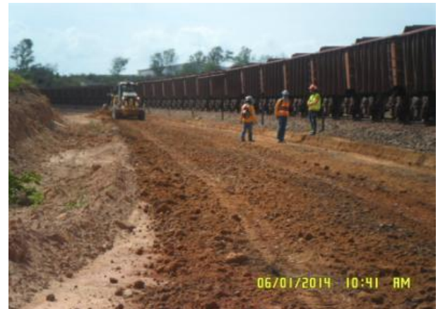
Foto 2-14: Terraplanagem para execução das posteriores etapas construtiva ao eixo ferroviário em duplicação (Locação 0-2).
