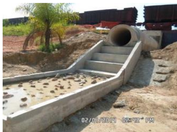
Foto 2-50: Bueiro simples tubular já prolongado e com posterior etapa de dissipação de energia ao fluxo hídrico da drenagem instalada ao longo do eixo ferroviário (Locação 47).
