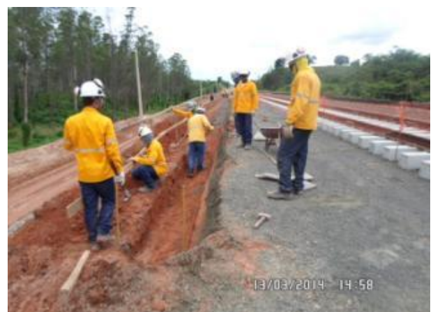
Foto 2-48: Trabalhadores realizando a construção da sarjeta ao eixo parcialmente duplicado (drenagem superficial permanente). (Locação 36).
