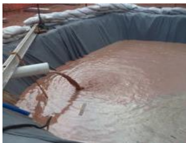
Foto 2-38: Bacia de decantação dos sólidos carregados pela atividade de perfuração para posterior reutilização nas demais perfurações (Locação 14).
