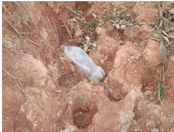
Foto 9: Lixo nas margens e marcas de gado a montante da ponte 04.
