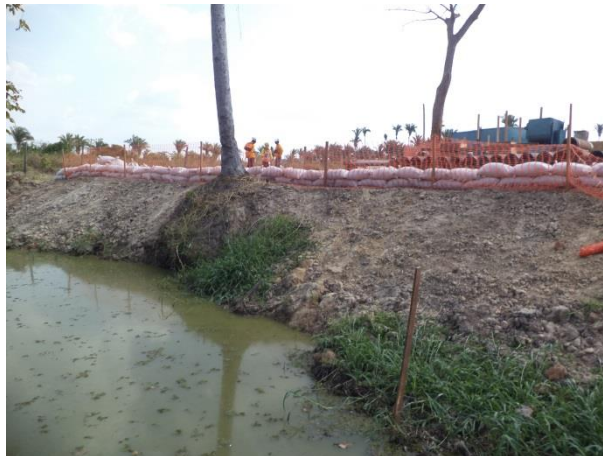
Foto 135: Detalhe das obras a montante da travessia 77, com presença de sistema de contenção temporária (rip rap). Foto: Ampla
