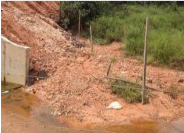
Foto 501: Detalhe do assoreamento na margem a jusante Foto: Amplo
