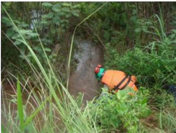
Foto 361: Montante da travessia 197 em janeiro de 2013. Foto: Ampla
