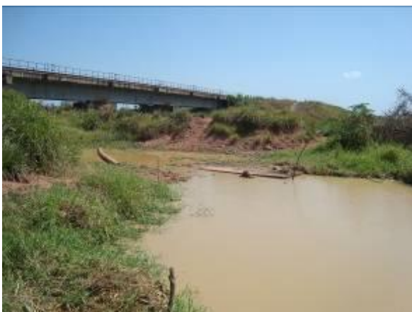
Foto 54: Montante da travessia 60 em janeiro/13.
