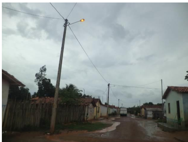
Foto 21: Iluminação pública existente em uma das vias da localidade Vila São João. Fonte: Ampla, 2014.
