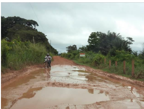
Foto 83: Condições da pavimentação na via do acesso BU02. Fonte: Ampla, 2014.
