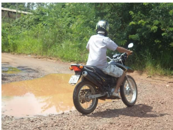
Foto 16-129: Condições de pavimentação e tráfego de veículo leve na via de Acesso AC03, em Açailândia/MA. Fonte: Ampla, 2014.
