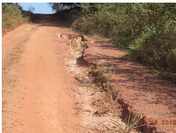
Foto 16-97: Condições da pavimentação do Acesso Viário CI02, em Cidelândia/MA. Fonte: AMPLO, 2014.
