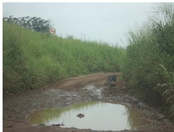
Foto 16-128: Condições de pavimentação do Acesso AC02, em Açailândia/MA. Fonte: Ampla, 2014.
