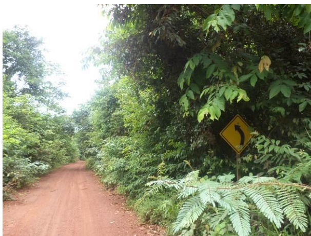
Foto 16-135: Condições da pavimentação e sinalização coberta pela vegetação no Acesso AC07, em Açailândia/MA. Fonte: Amplo, 2014.
