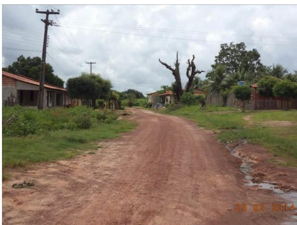
Foto 16-57: Condições do pavimento da via de acesso SI01, Santa Inês/MA. Fonte: Ampla, 2014.
