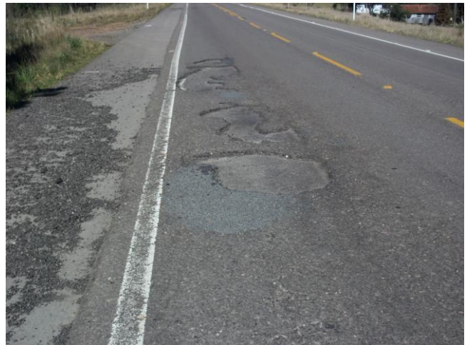
Foto 04: Detalhe da deterioração da capa asfáltica junto ao km 4+500, Subtrecho Contendas-Aratinga, Lote III.
