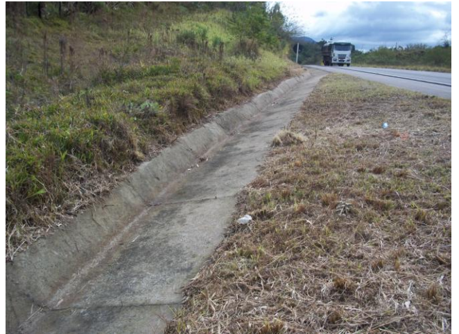
Foto 02: Atividades de roçada e limpeza das canaletas de drenagem em andamento no Lote I.
