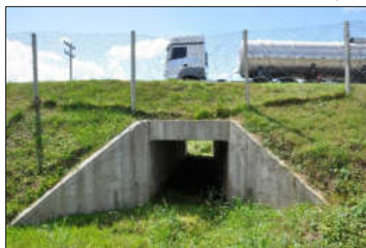
Foto 550. Passagem inferior para a fauna adaptada em bueiro celular, com cercas direcionadoras na BR-392 em Rio Grande/RS.
