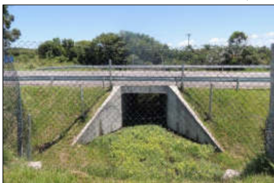
Foto 549. Passagem inferior para a fauna adaptada em bueiro celular, com cercas direcionadoras na BR-392 em Rio Grande/RS.
