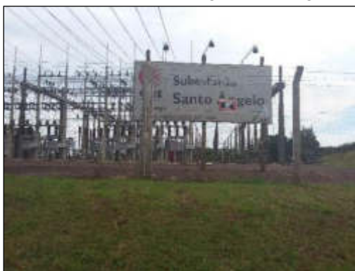
Foto 542. Subestação de energia de Santo Ângelo.
