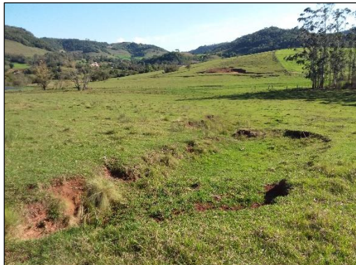
Foto 118. Cicatriz de movimento de massa, área com risco geotécnico moderado. Coord.: -29,524723° e -54,152229°.
