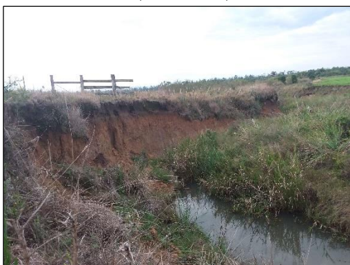
Foto 124. Processo erosivo relacionado a curso hídrico. Coord.: -29,846717° e -53,767121°.
