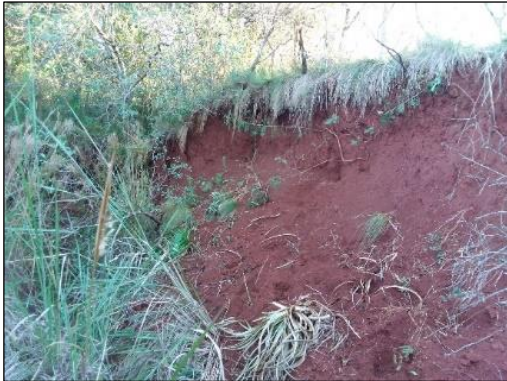
Foto 101. Ocorrência de ravinamento. Coord.: -28,583814° e -54,421993°.
