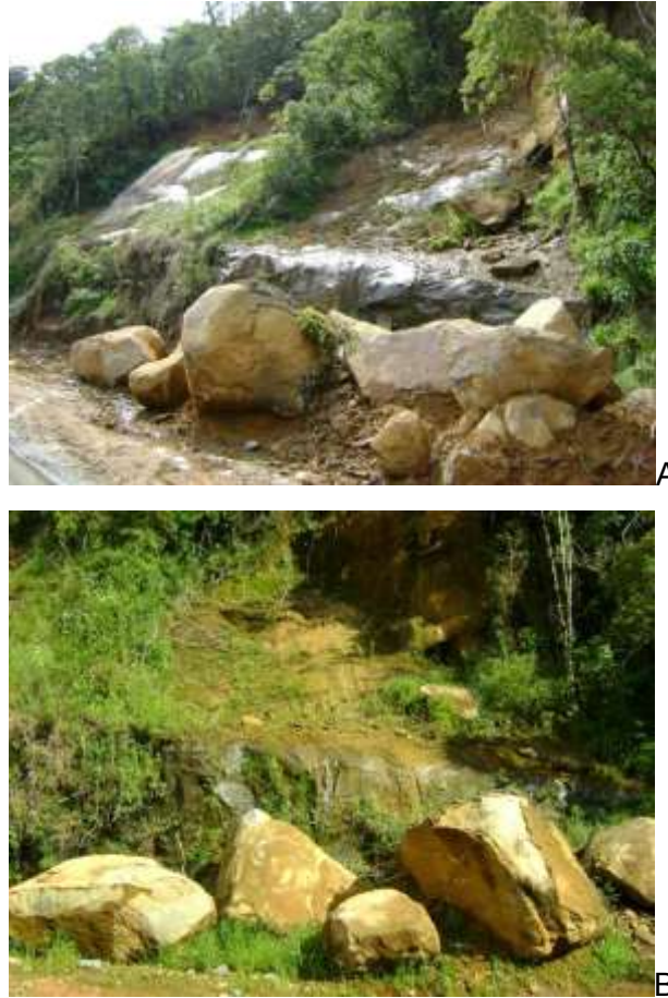
Figura 05 - Exemplos em que o caimento em direção à estrada das fraturas subparalelas a topografia exerceram um condicionante predominante no desencadeamento dos processos de movimentação de massa de solo e rochas. A) Ponto EPC; B) Ponto 1EPC-15 (=2EPC8).
