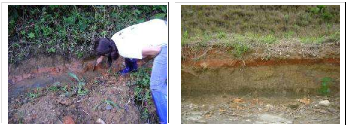
Figs. 9 e 10 Sedimento argiloso depositado em canal de drenagem e na estrada
