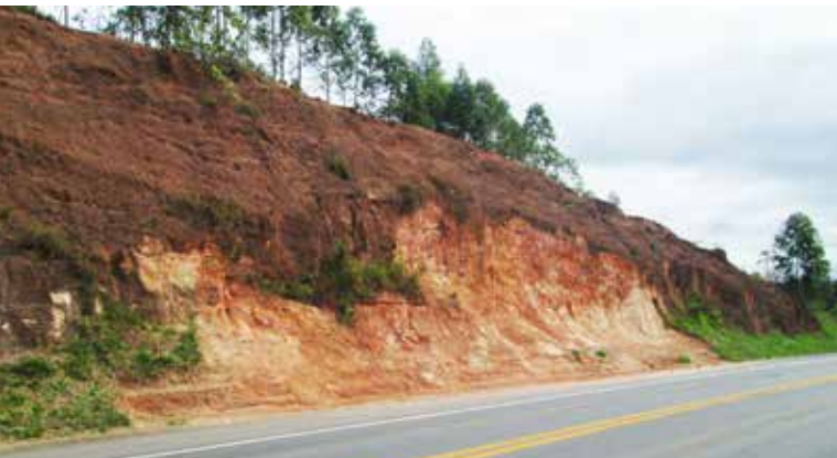
Talude de corte em sedimentos da Formação Barreiras exposto à ocorrência de processos geodinâmicos
