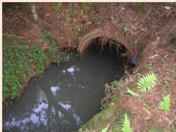
FIGURA 62 – DETALHE DA VALA DE DRENAGEM COM GRANDE APORTE DE MATÉRIA ORGÂNICA NA CONFLUÊNCIA COM O AFLUENTE DO RIO PALMITAL A MONTANTE DO PONTO OHL 05
